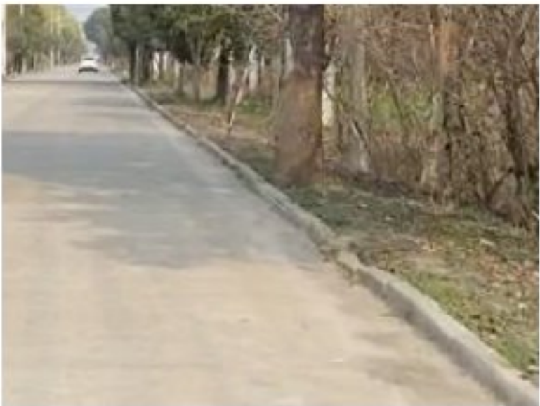
现状破损混凝土侧石
