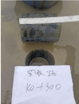
1#砼板块，混凝土面层厚度 18.5cm，基层松散未取出。
