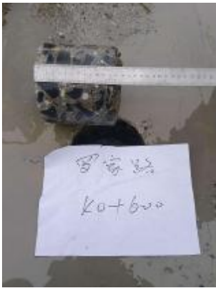
2#砼板块，混凝土面层厚度 13.5cm，基层松散未取出。
