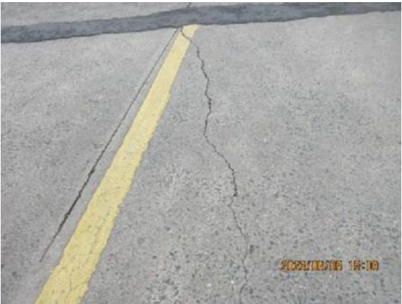
图 4-4 白沙桥混凝土铺装层纵向开裂
