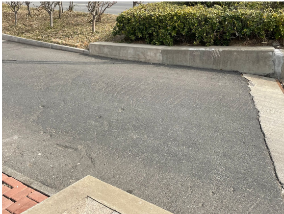
图 4-3 盐津大桥桥头跳车
