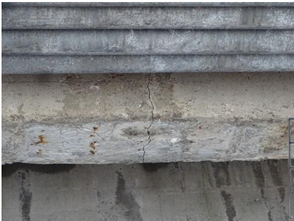
图 5-1 北侧 3#纵梁 U 型开裂
