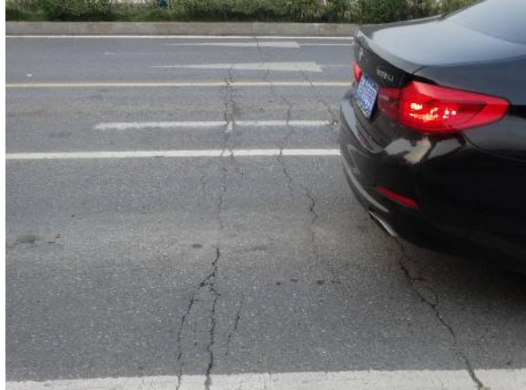
图 4-3 永兴路盛唐桥 2#孔桥面铺装机动车道横向裂缝
