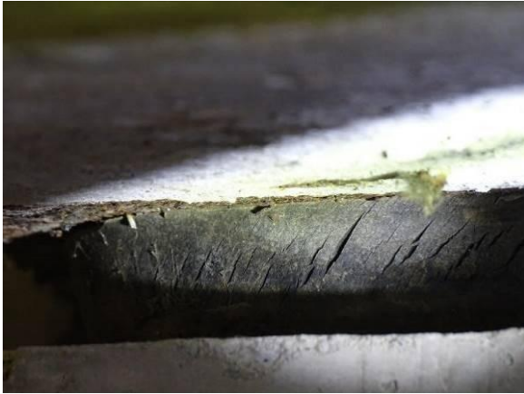
图 4-36 吴陵路吴陵桥 3-1#支座(板)老化开裂
