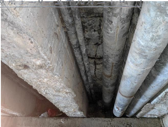
图 5-4 南侧纵梁顶部盖板断裂
