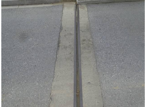
图 4-11 扬州路九龙桥 0#墩(台)伸缩装置堵塞
