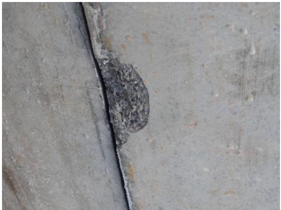
图 4-25 扬州路九龙桥 1-2#梁底板破损
