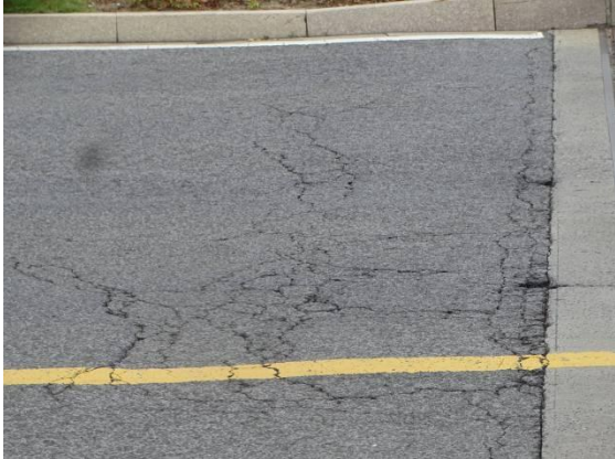
图 4-6 扬州路九龙桥 1#孔桥面铺装机动车道龟裂
