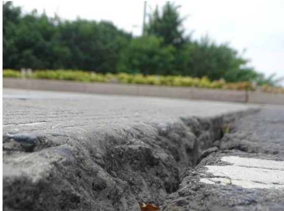
图 4-1 扬州路九龙桥 0#台桥路连接桥头跳车，高差 2~5cm
