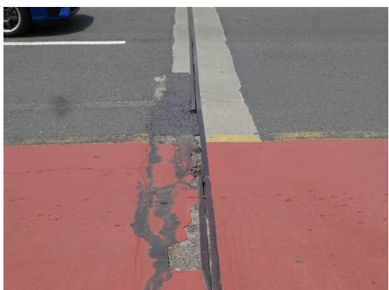
图 4-7 青年路西池寺桥 3#墩(台)伸缩装置锚固砼破损，型钢缺失
