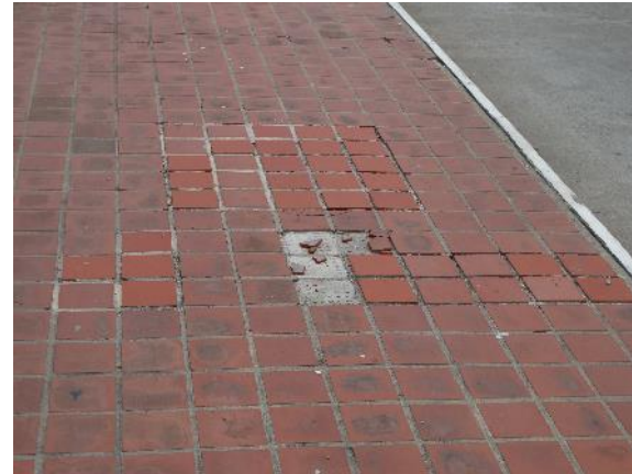
图 4-15 迎春路西门桥 1 人行道路缘石面板缺失
