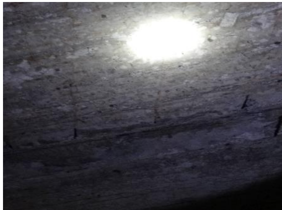
图 4-28 鼓楼南路芦洲桥 1-20#梁底板露筋锈蚀
