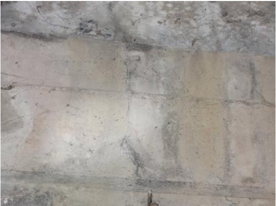
图 4-30 鼓楼南路芦洲桥 0#台台帽竖向裂缝
