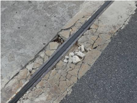
图 4-8 迎春路西门桥 3#台伸缩装置锚固砼破损
