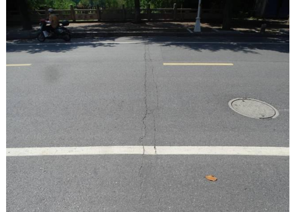
图 4-12 迎宾路礼宾桥 1#孔桥面铺装横向裂缝(无伸缩装置)
