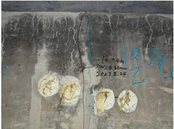
图 4-29 济川路凌家桥 3#台台帽竖向裂缝
