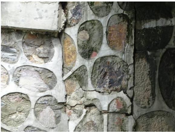
图 5-11 0#台翼墙墙身横向开裂
