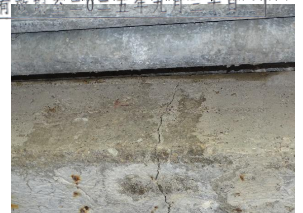
图 4-22 迎宾路礼宾桥 3#小纵梁 U 型开裂
