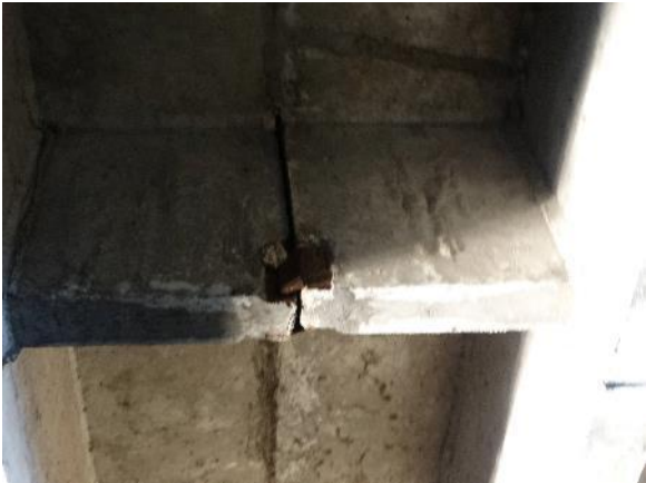
图 4-24 青年南路希望桥 T 梁横隔板钢板外露
