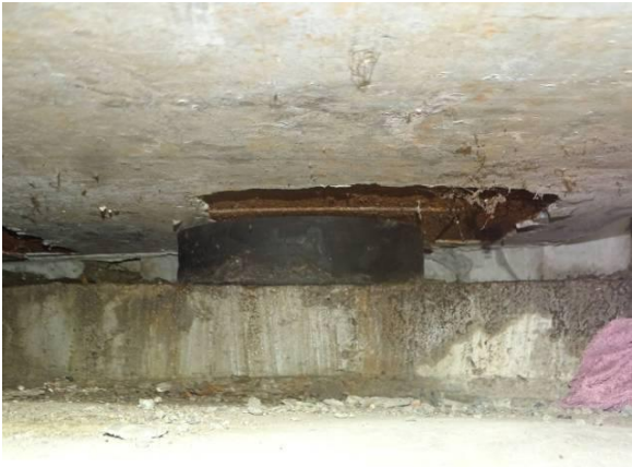
图 4-37 扬州路九龙桥 0-1#支座移位
