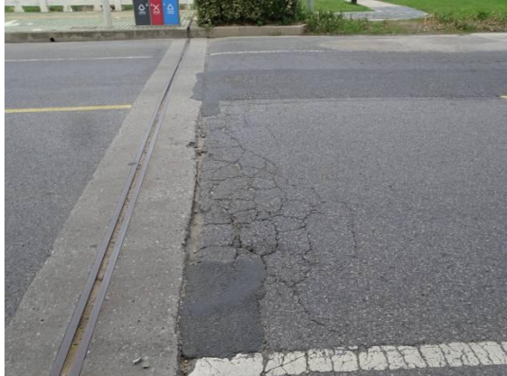
图 4-5 春晖路水深桥 0#桥头搭板铺装层龟裂
