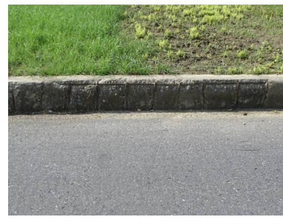
图 4-16 济川路凌家桥 全桥左侧绿化带路缘石露筋
