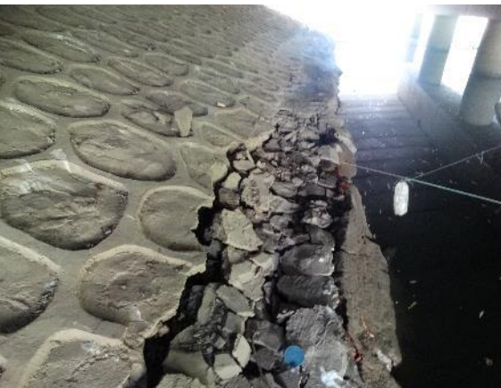
图 4-34 森园路祥和桥 3#台护坡脚损坏
