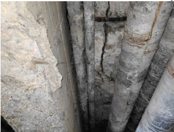
图 5-3 南侧纵梁顶部盖板断裂
