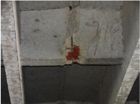
图 4-23 江州路景庄桥 T 梁横隔板钢板外露
