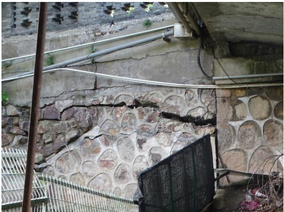
图 5-6 翼墙墙身横向开裂
