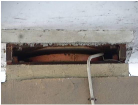
图 4-38 海陵南路渡江桥 全桥桥墩支座钢构建轻微锈蚀
