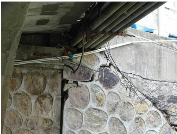
图 5-12 0#台翼墙墙身横向开裂
