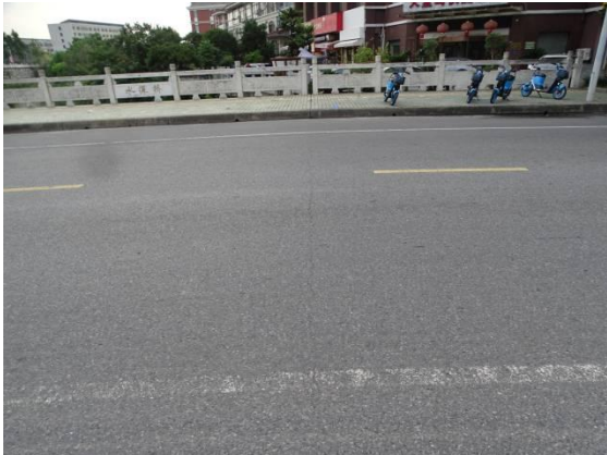
图 4-2 春晖路水深桥 1#孔桥面铺装机动车道横向裂缝
