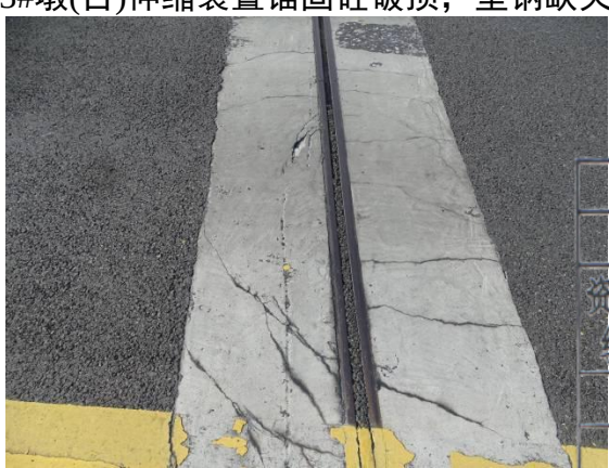
图 4-9 梅兰东路彩凤桥 0#墩(台)伸缩装置锚固砼网裂、破损
