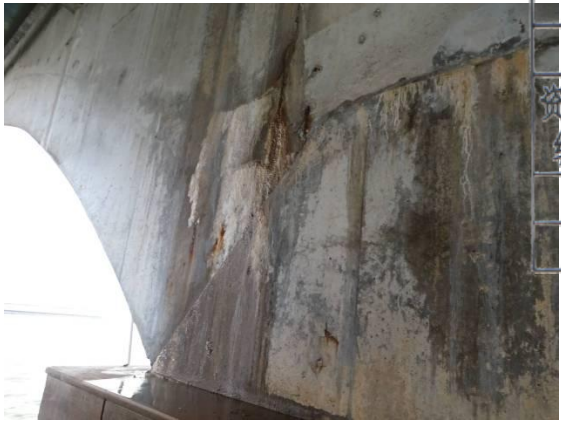
图 4-31 鼓楼路鼓楼大桥 2-3#墩墩帽左侧面破损露筋
