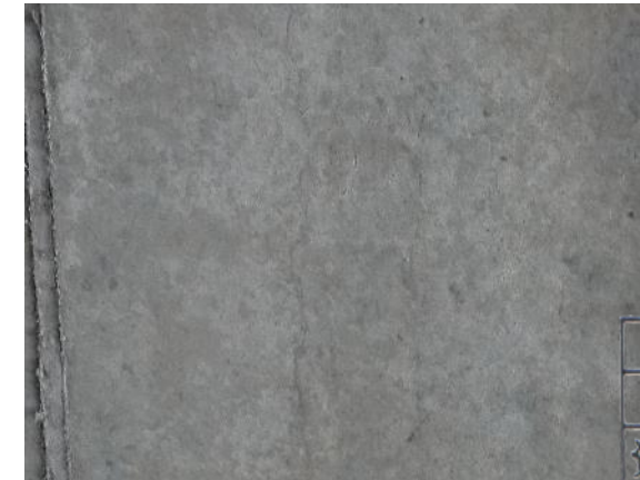
图 4-19 济川路凌家桥 2-9#梁底板纵向裂缝
