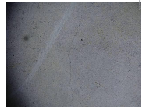
图 4-21 春晖路水深桥 2-6#梁底板横向裂缝
