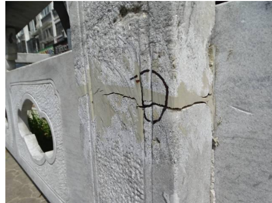
图 4-13 永兴路西刘河桥 左侧人行护栏杆件开裂
