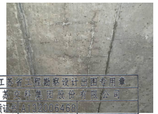
图 4-20 扬州路九龙桥 1-4#梁底板析白（结晶物），纵向析白
