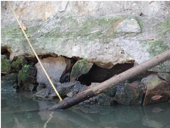
图 5-7 翼墙基础掏空
