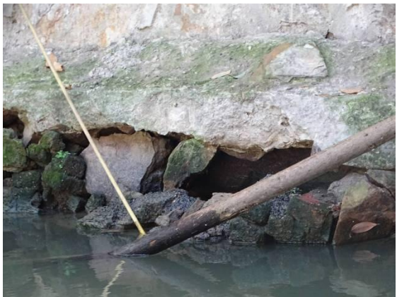
图 4-33 海陵南路爱民桥 1#台右侧翼墙塌落，基础下沉，翼墙开裂
