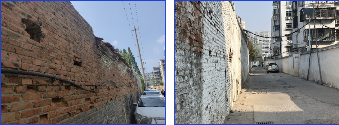
墙体缺砖、粉化
