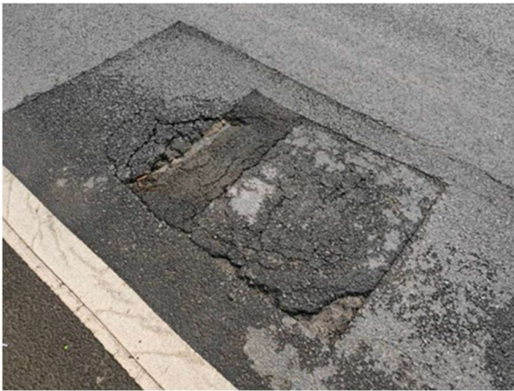
桥面铺装层破损
