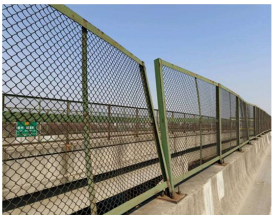
防抛网变形错位、锈蚀
