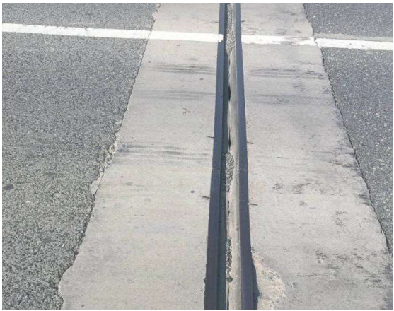
伸缩缝止水带破损
