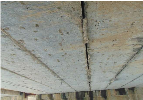
勾缝脱落、铰缝渗水
