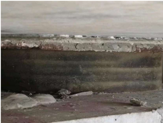
橡胶支座老化开裂
