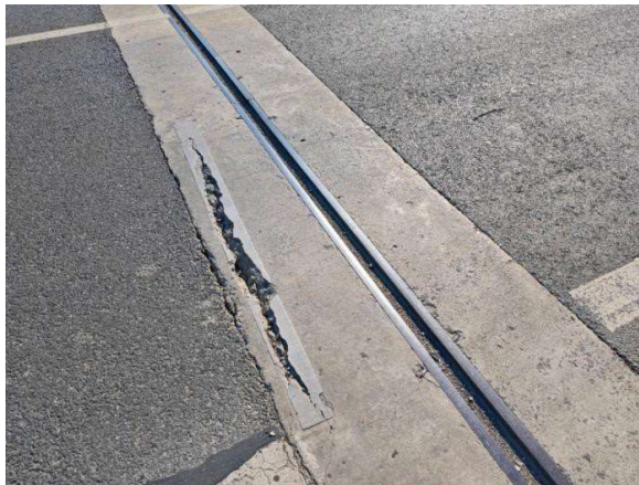
伸缩缝锚固混凝土破损
