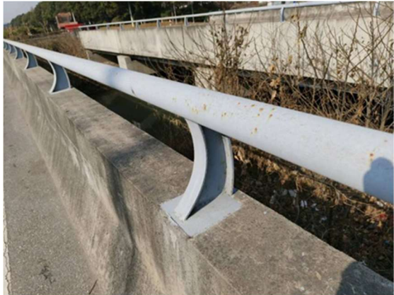
栏杆护栏钢构件锈蚀
