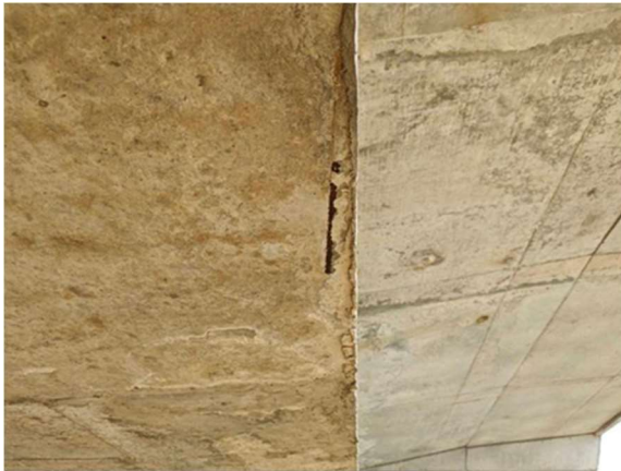
梁底破损锈胀露筋（主筋）
