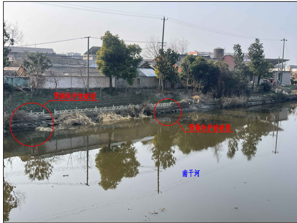
南干河预制块护坡破损处现状
