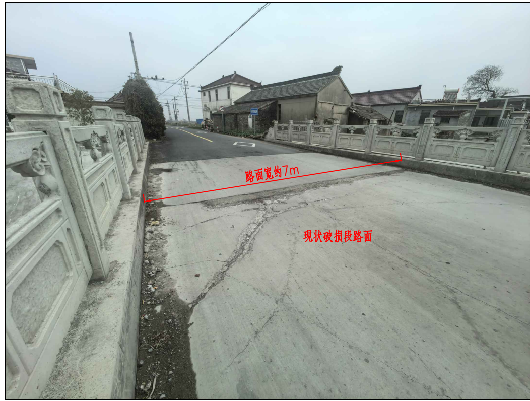
银穆新华界河姜银线处路面破损处现状
