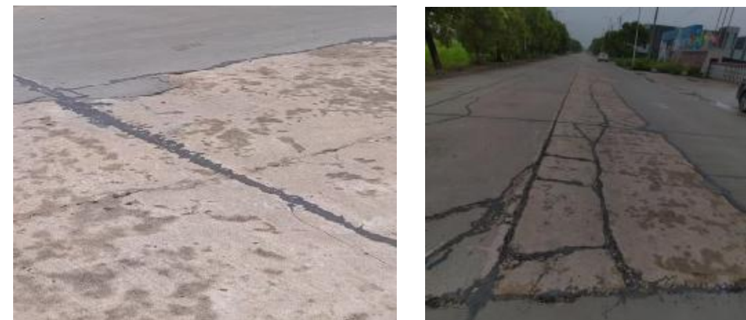
图 3-4 混凝土路面病害
