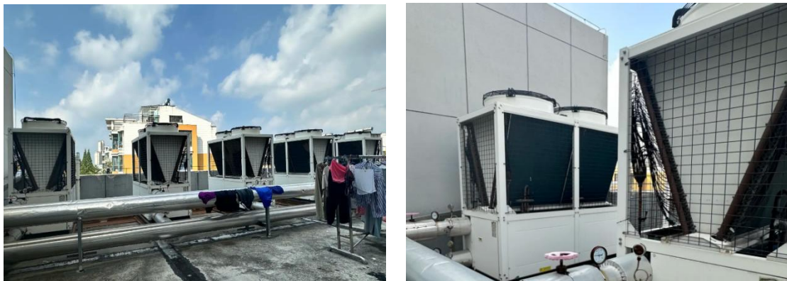
图 2.2.2-3 空气源热泵机组
