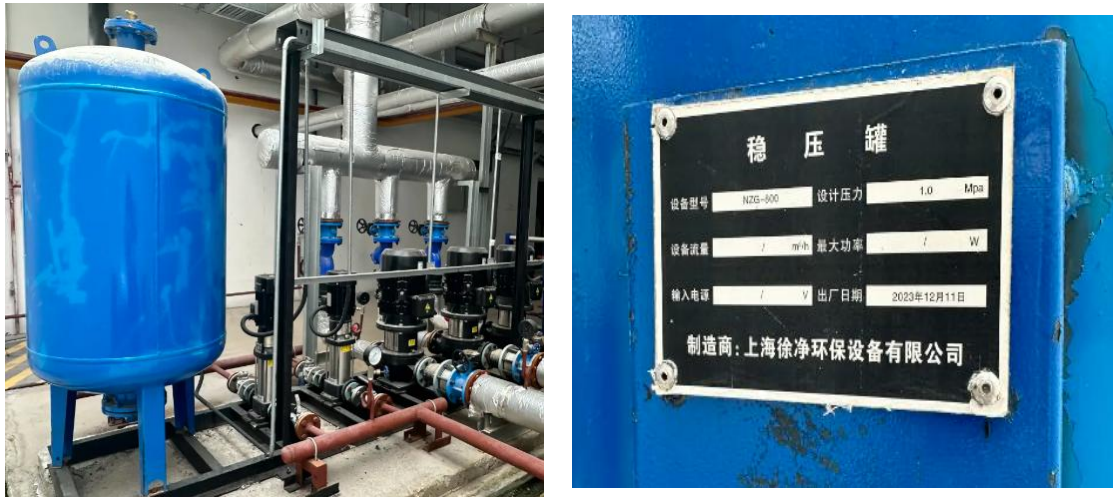
图 2.2.7-3 稳压罐及铭牌
