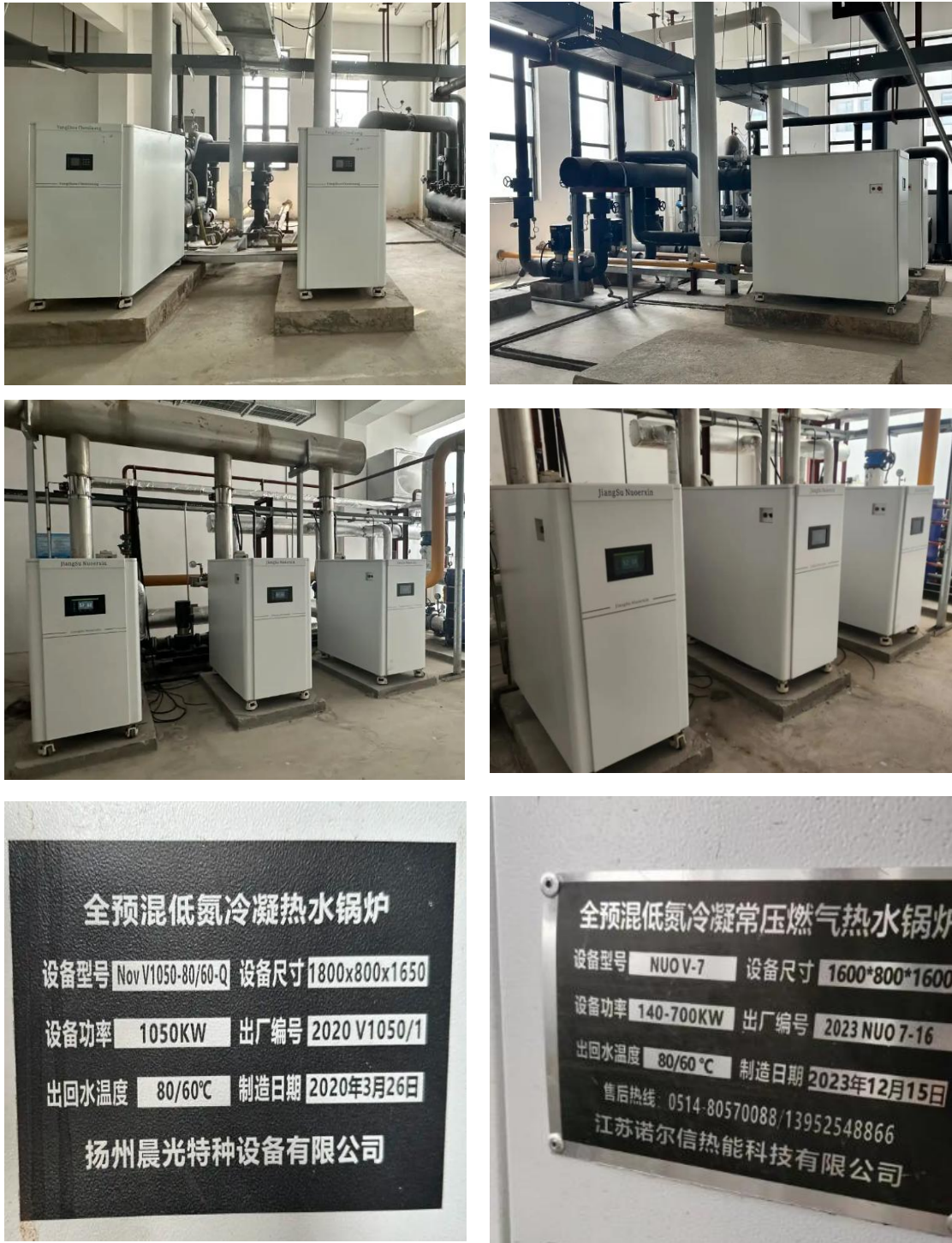
图 2.2.2-4 热水锅炉及铭牌
