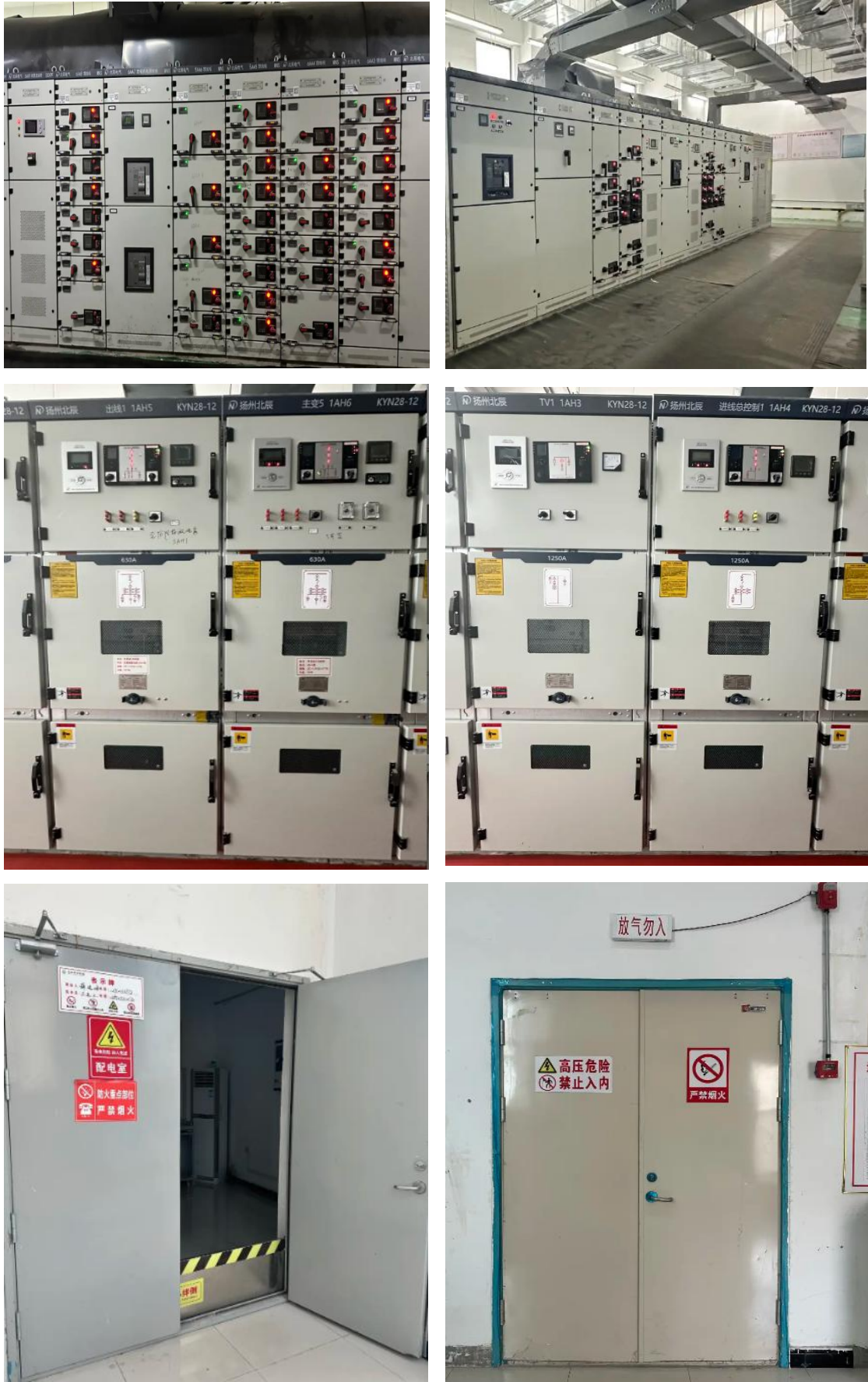
图 2.2.1-1 高低压配电室
