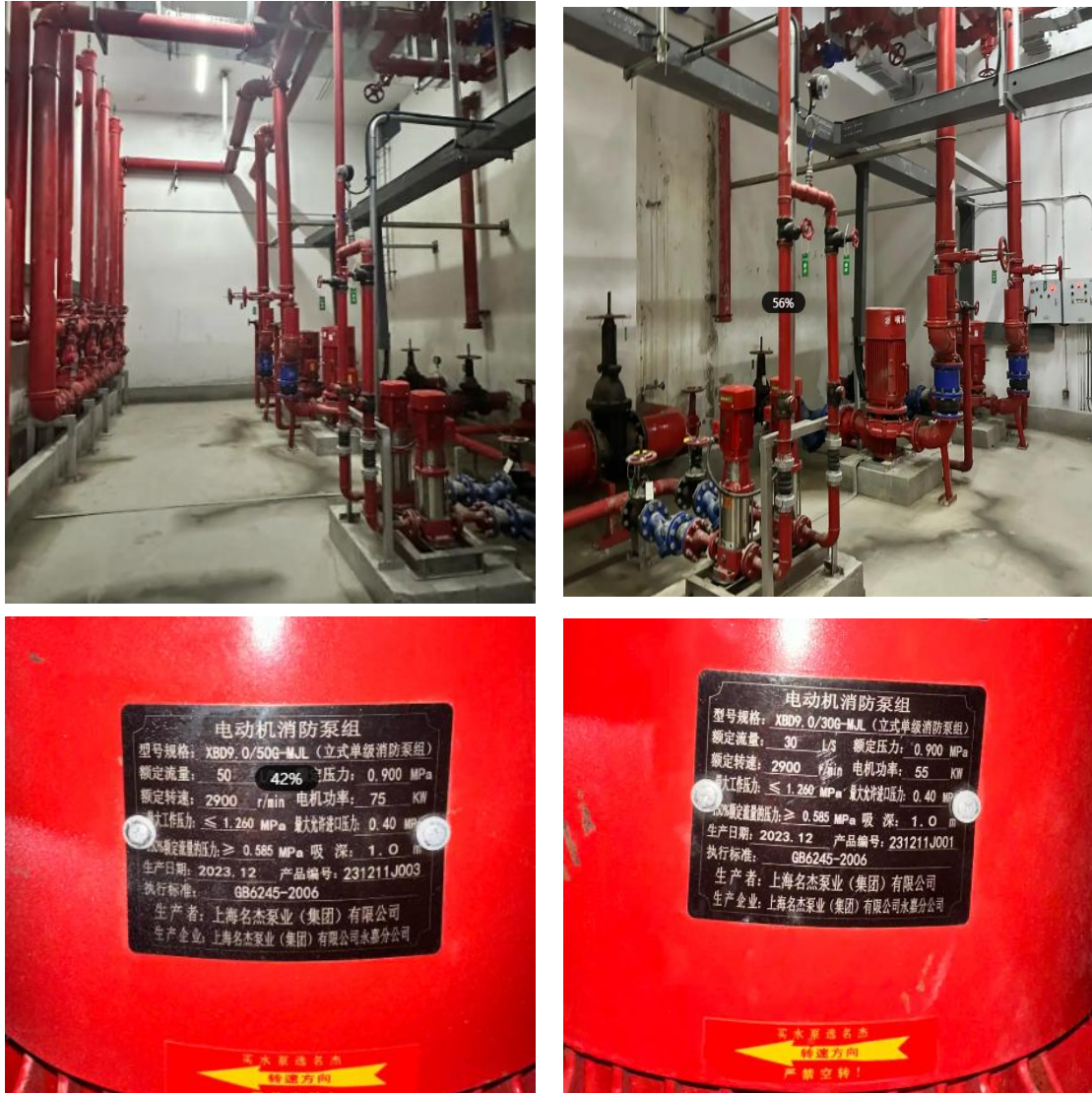
图 2.2.7-5 消防水泵及铭牌
