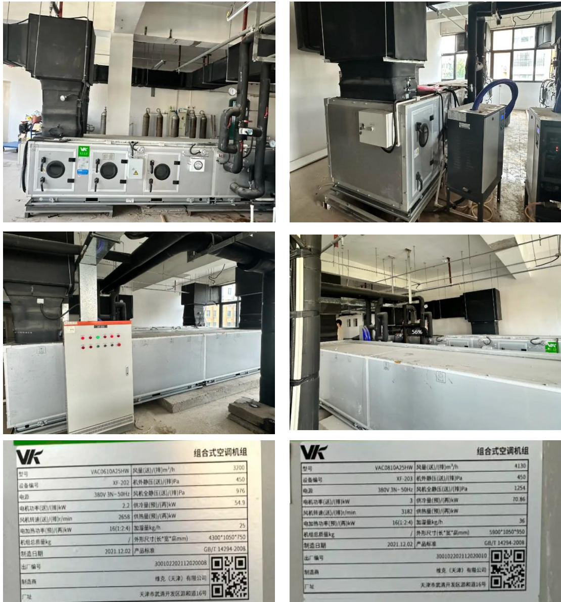
图 2.2.4-1 恒温恒湿空调机组及铭牌
