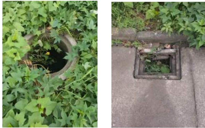
图 3-5 井盖缺损、雨水篦缺损
