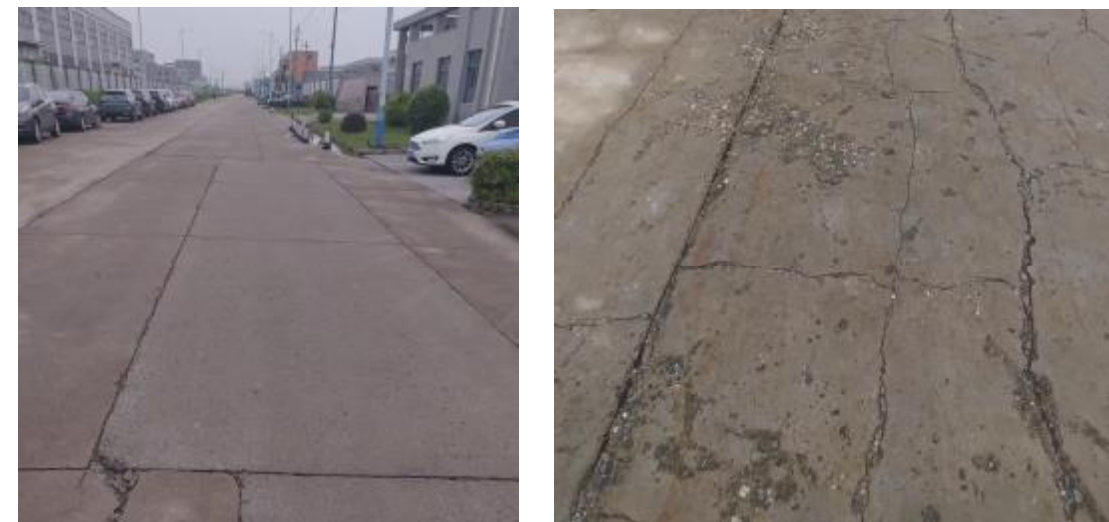
图 3-4 混凝土路面病害
