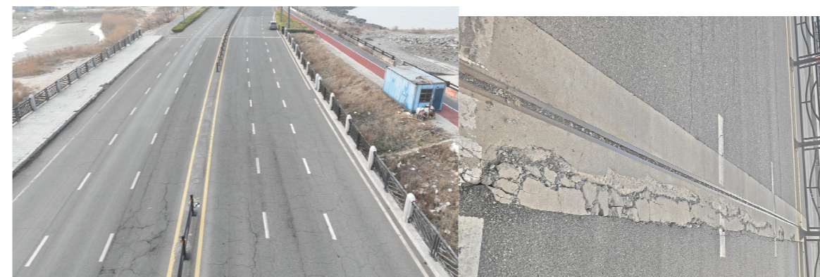
小丁港桥桥面现状
