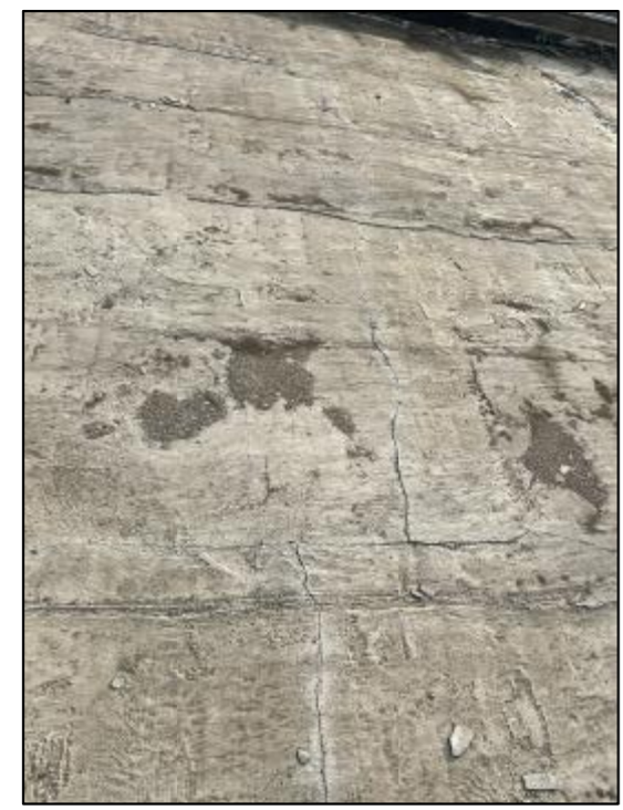
屋顶因防水层老化，后做的混凝土保护层开裂，漏水严重。维修时，需清理原有屋面破损基层，砂浆找平后，涂非固化防水涂料并铺防水卷材。
