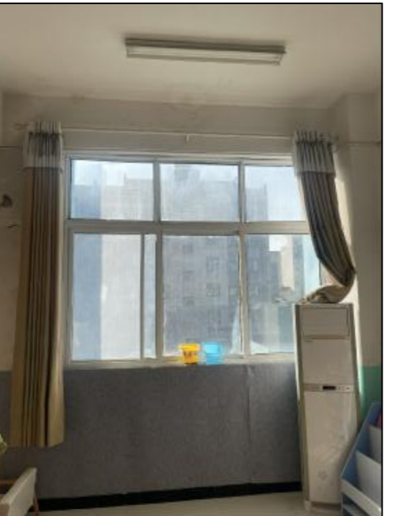
外窗因材料原因及使用时间较长, 造成变形严重。 建议更换外窗。
