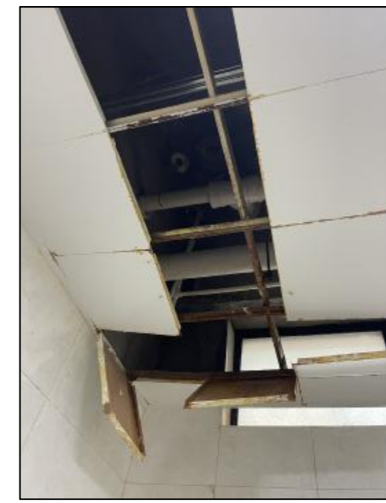
顶棚因屋顶漏水原因，造成污损计破损。因漏水造成的顶棚污损破坏面积按一半面积计。清除原有污损计破损的面层，重新粉刷找平后，涂防水涂料。最后修补原有吊顶。
