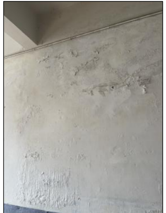
普通内墙因屋顶及外墙漏水原因, 造成污损计破损; 卫生间内墙因屋顶及环境潮湿原因, 造成污损计破损。 因漏水造成的内墙污损面积按一半面积计。 清除原有污损计破损的面层, 重新粉刷找平, 防水水材料后, 刮腻子后喷涂涂料。
