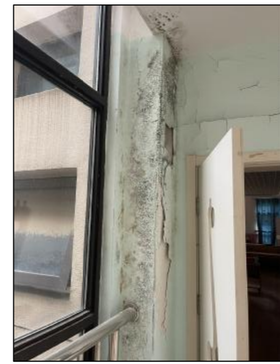
普通内墙因屋顶及外墙漏水原因，造成污损计破损；卫生间内墙因屋顶及环境潮湿原因，造成污损计破损。因漏水造成的内墙污损破坏面积按一半面积计。清除原有污损计破损的面层，重新粉刷找平，涂防水材料后，刮腻子后喷涂涂料。
