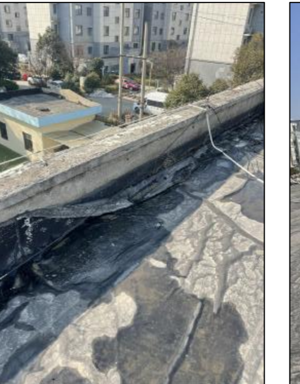
屋顶因防水层老化, 漏水严重。 维修时, 需清理原有屋面破损基层, 砂浆找平后, 涂非固化防水涂料并铺防水卷材。
