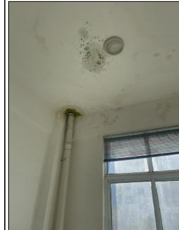
顶棚因屋顶漏水原因, 造成污损计破损。 因漏水造成的顶棚污损面积按一半面积计。 清除原有污损计破损的面层, 重新粉刷找平后, 刮腻子后喷涂涂料。
