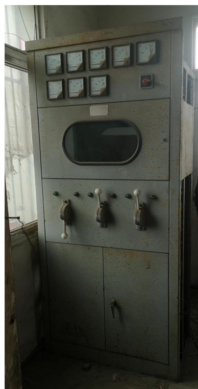
配电控制柜现状
