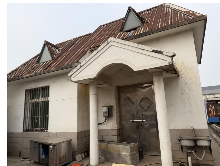
森北泵站现状
