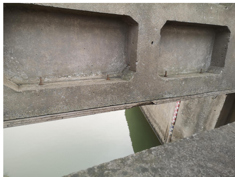
闸门木止水现状
