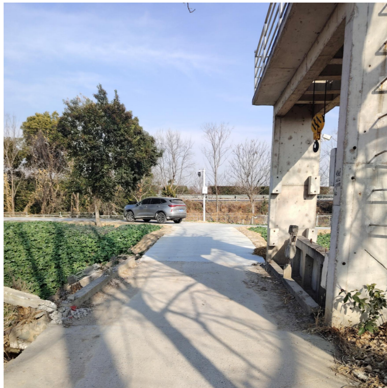
新河交界闸桥栏杆现状
