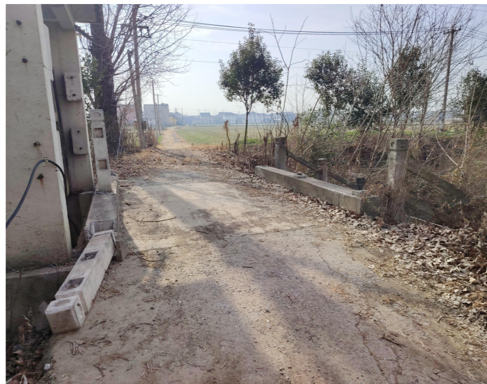
三十亩沟闸桥栏杆现状
