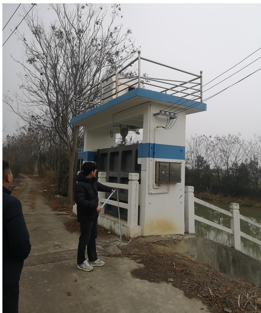
八号河东闸工作桥栏杆现状
