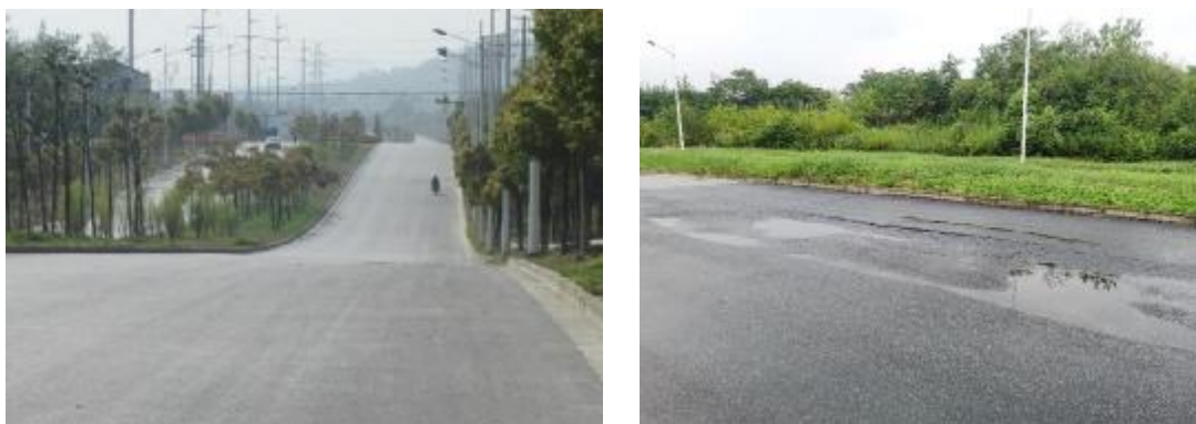
图2-15 道路纵坡大、路面破损严重
