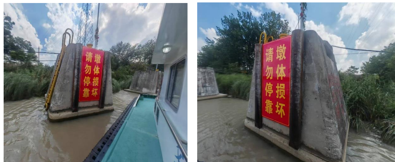
图2-5 一号船闸上游19#靠船墩现状图
