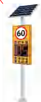
长下坡终点位置，桩号K1+400 道路西侧太阳能测速仪
