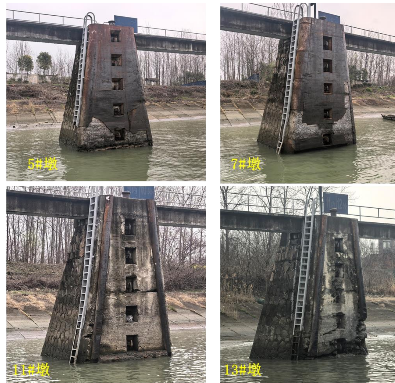
图 2-6 靠船墩现状典型破损图 (1)
