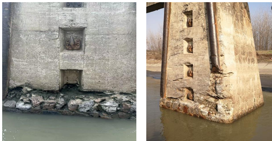
图 2-9 靠船墩破损细部图
