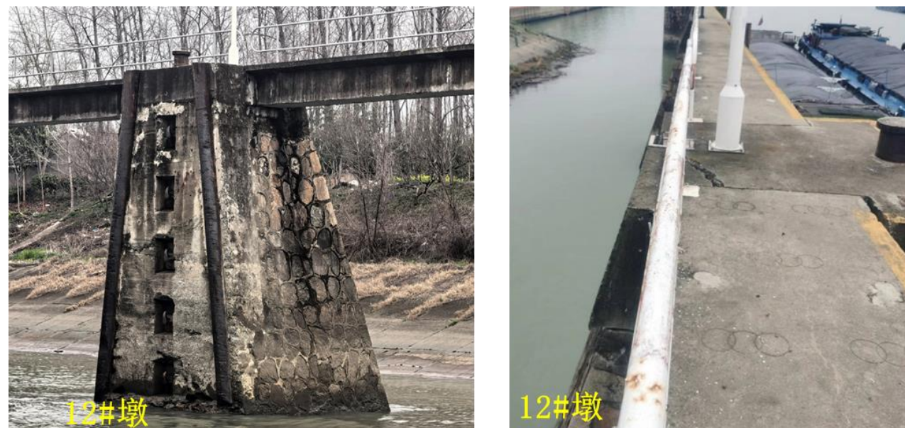
图 2-7 靠船墩现状典型破损图 (2)
