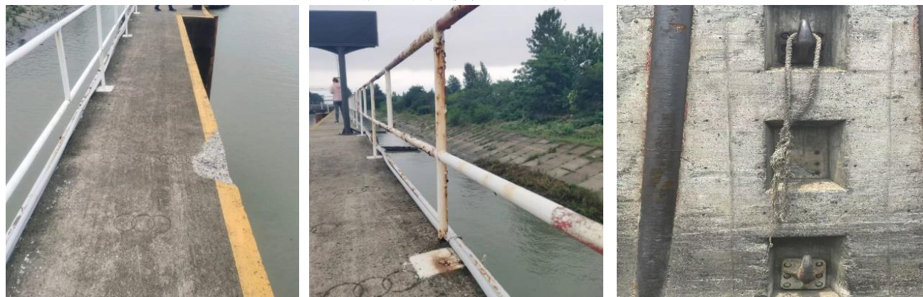
图 2-8 靠船墩附属设施缺损图
