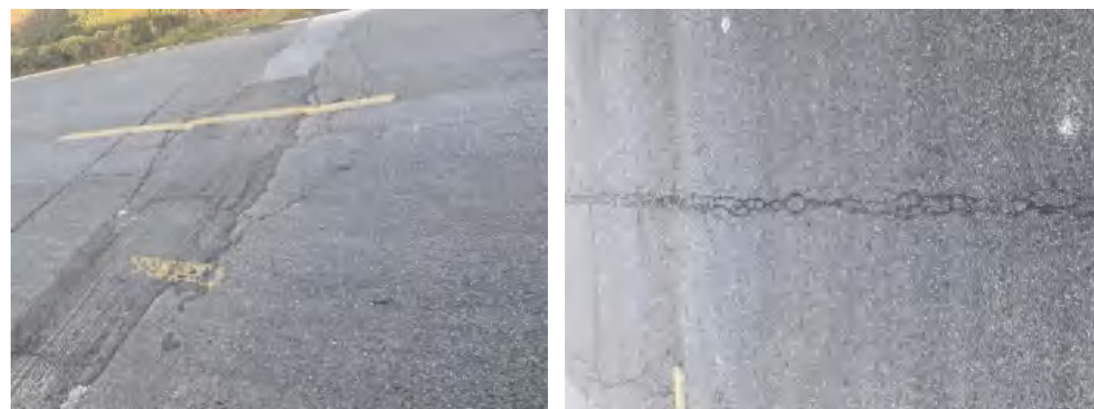
现状路面病害（沥青砼路面）
