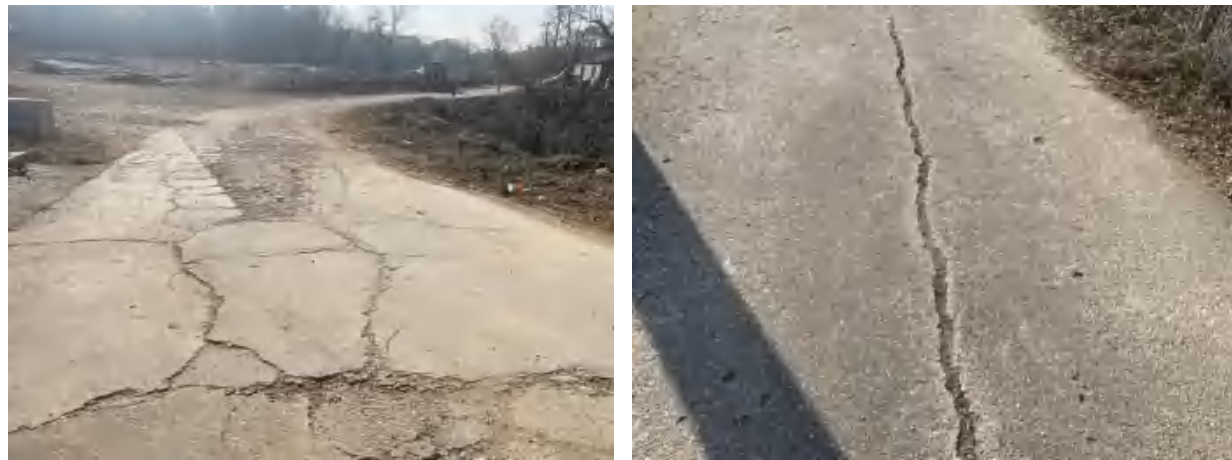
现状路面病害（水泥砼路面）
