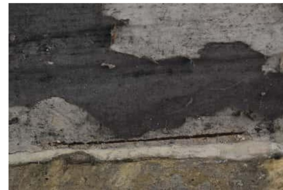
图 4.3-3 2#底板混凝土破损露筋
