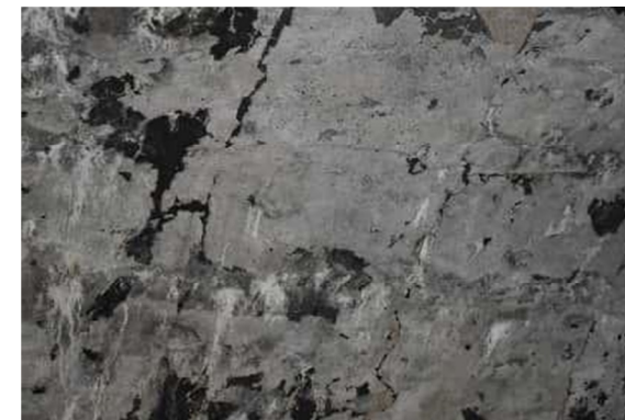
图 4.6-3 主拱圈拱顶裂缝
