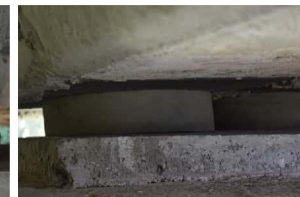
图 4.2-6 支座 4-1-2 老化变形
