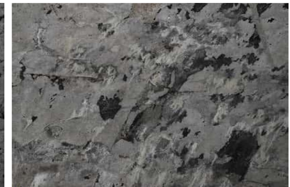
图 4.6-4 主拱圈拱顶横向裂缝
