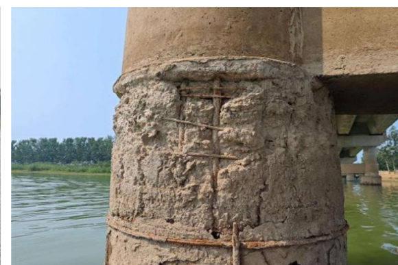
图 4.2-10 4-2#桩基砼破损、钢筋笼外露
