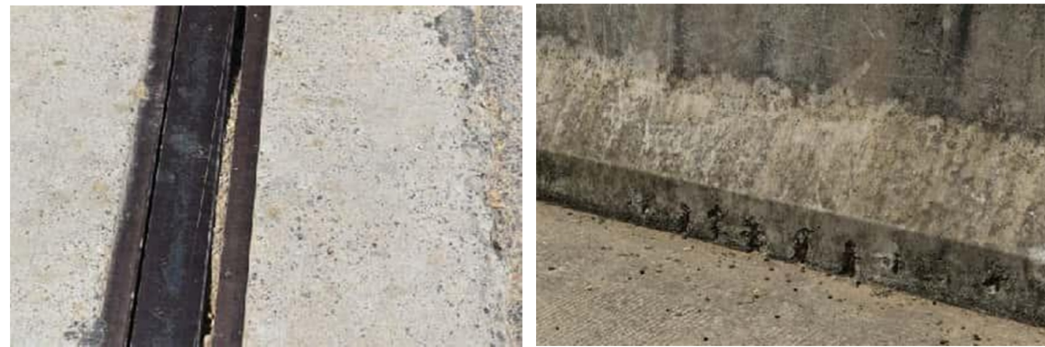
图 4.2-7 0#台伸缩缝变形
