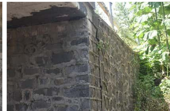
图 4.3-6 2#桥台右侧竖向裂缝倾斜
