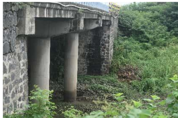
图 4.4-5 1-1#立柱砼破损露筋
