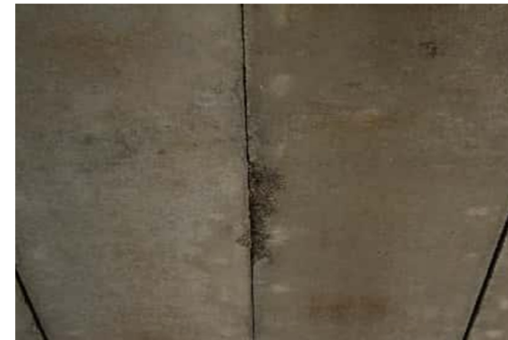
图 4.1-3 梁板 2-4#底板混凝土破损
