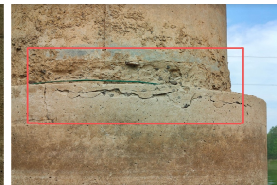
图 4.5-6 2-2#桩混凝土破损
