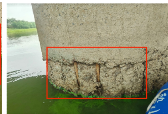
图 4.1-6 3-2#桩基破损露筋
