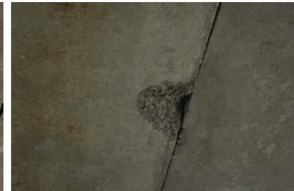
图 4.1-4 梁板 2-10#底板混凝土破损
