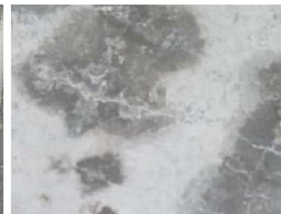
图 4.4-4 3-5#底板纵向裂缝
