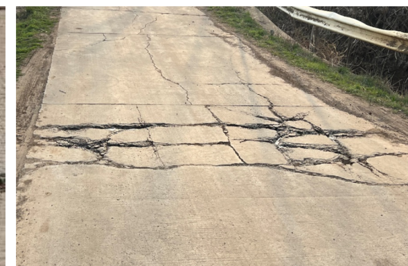
4.3-8 0#桥头路面破碎板
