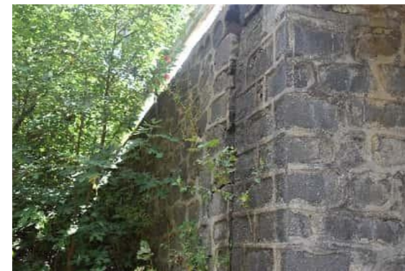
图 4.3-5 0#桥台右侧竖向裂缝倾斜
