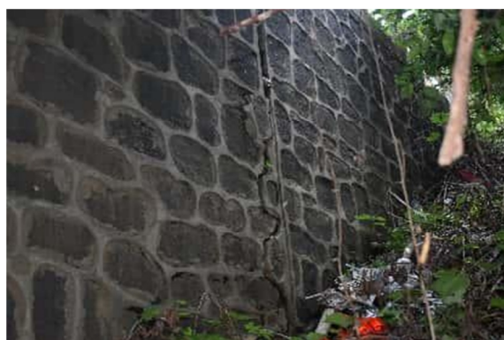
图 4.6-5 0#桥台左侧开裂
