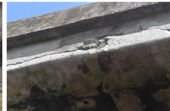
图 4.3-4 2#腹板混凝土破损露筋
