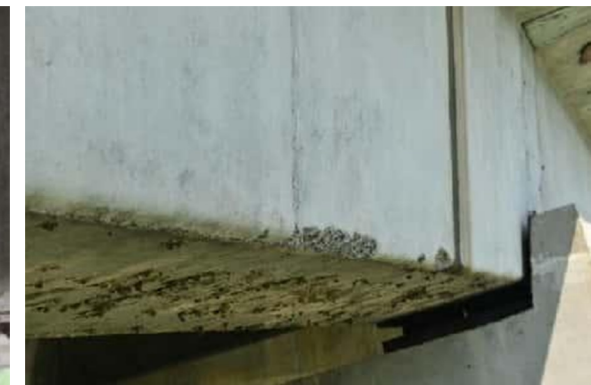
图 4.2-4 3#墩箱梁外侧砼剥落
