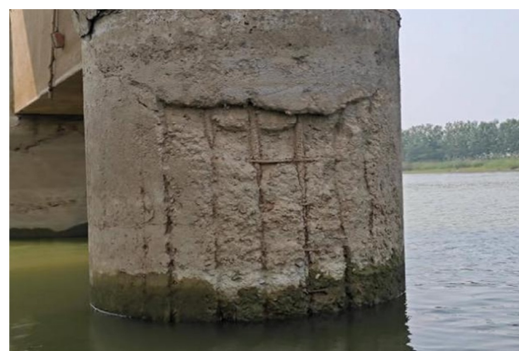
图 4.2-9 2-1#桩基砼破损、钢筋笼外露
