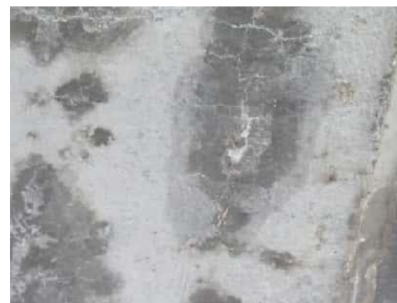
图 4.4-3 1-6#底板纵向裂缝
