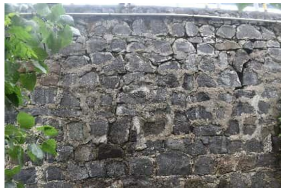
图 4.4-6 3#桥台右侧斜向裂缝
