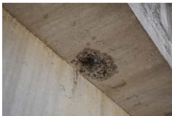
图 4.5-3 3-1#右翼板混凝土破损
