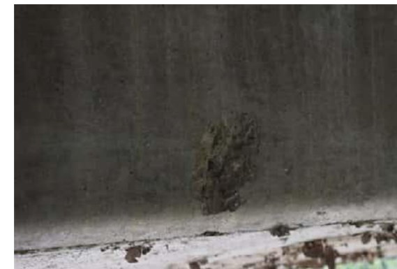
图 4.2-3 1-1#箱梁底板砼剥落
