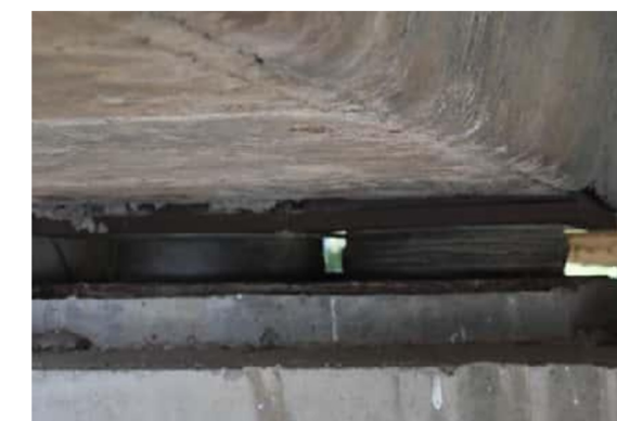
图 4.2-5 支座 7-3-1、7-3-2 老化变形
