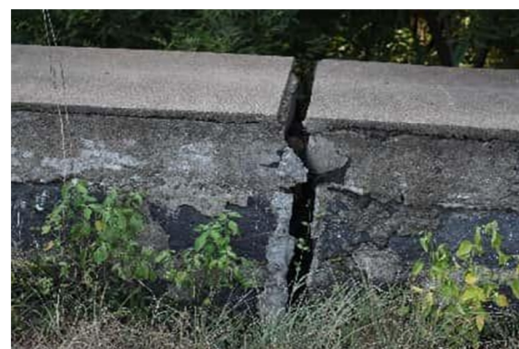
图 4.6-8 左护栏基础开裂
