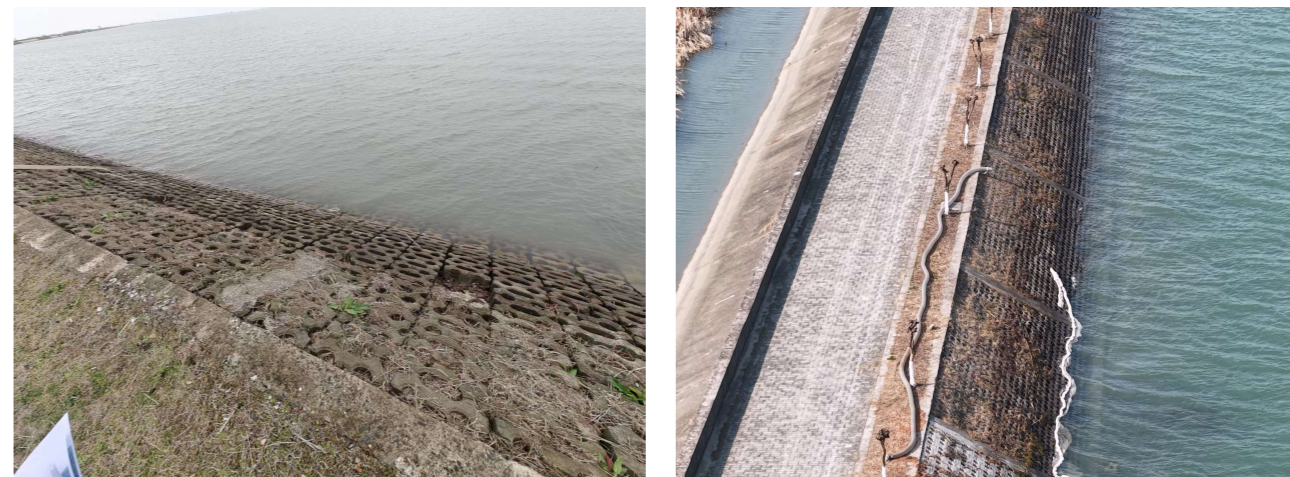
现场护坡损坏照片
