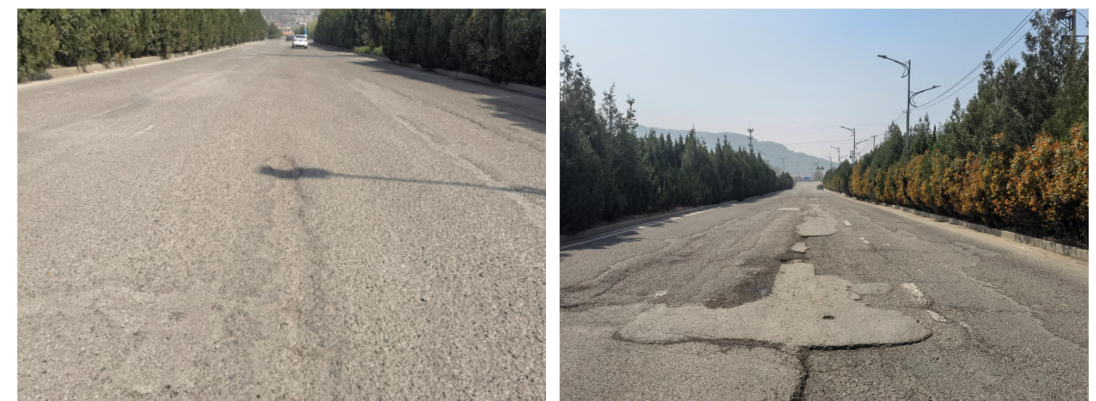
标线磨损严重
