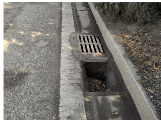
缺失铸铁井盖
