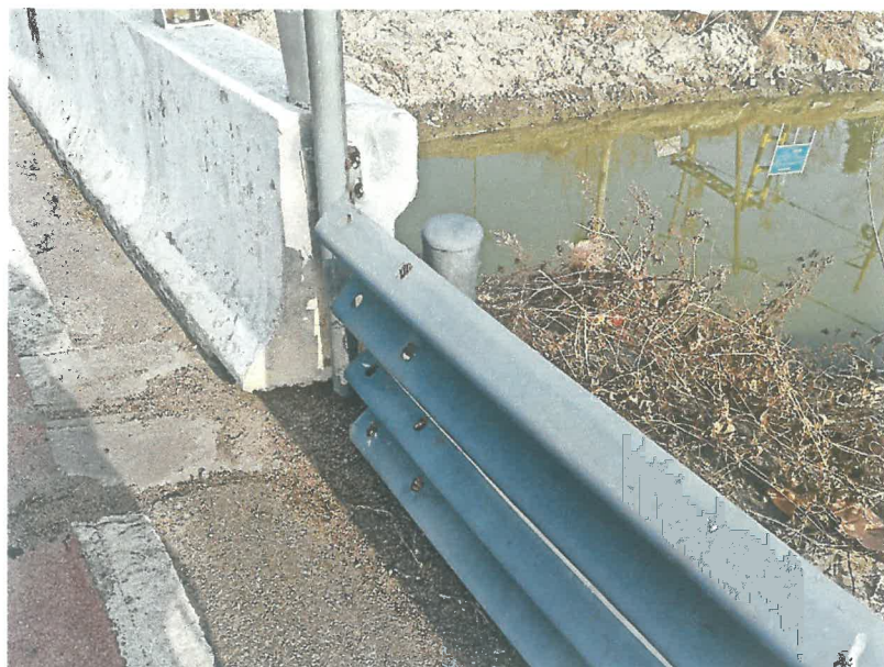
桥头护栏未刚性连接
