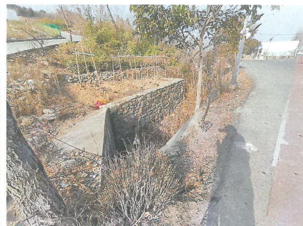
紧邻路侧的沟渠缺少护栏防护
