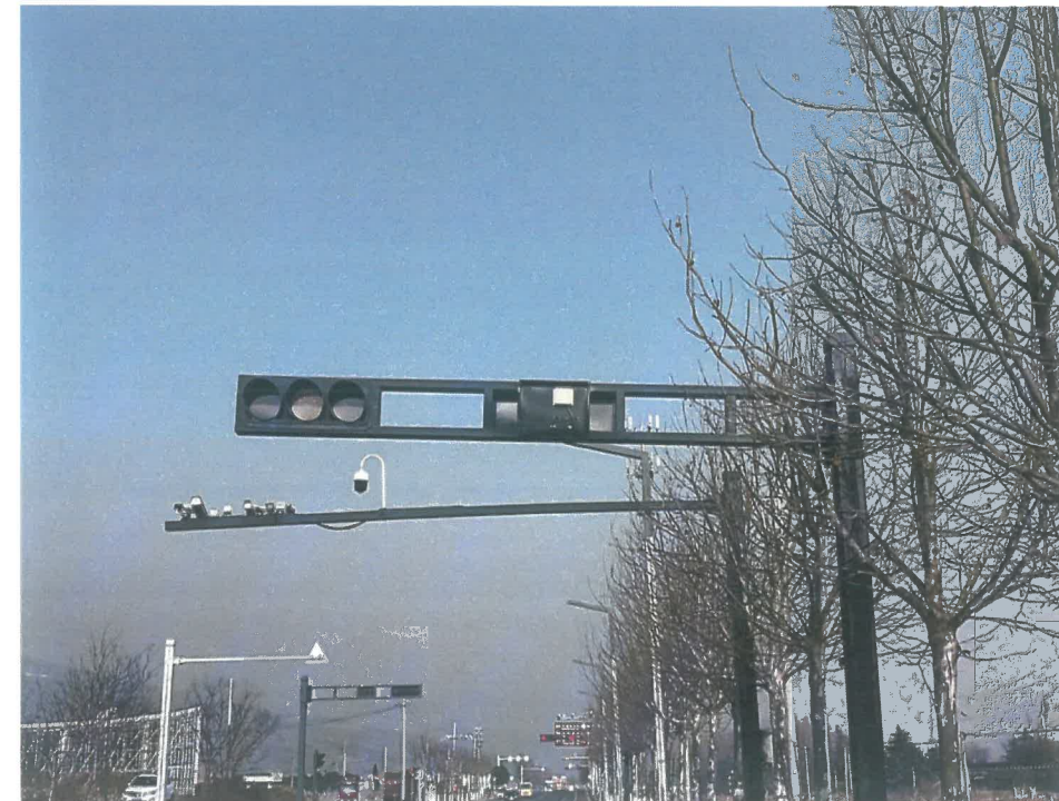
与悟空路西交叉口倒计时器损坏
