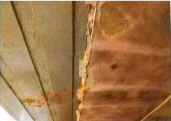
(b) 1-11#一般构件勾缝脱落 L=2.00m
