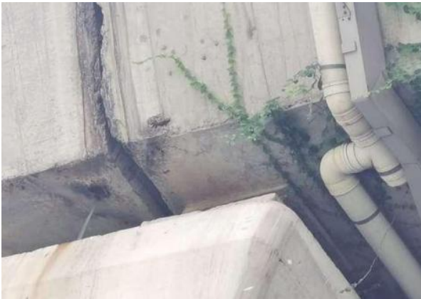
(a) 1-1#箱梁右腹板，距 0#台 0m 处，锈胀露筋
