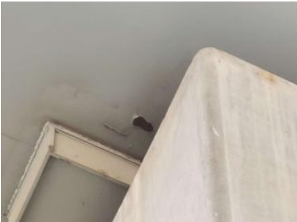
140-1#底板涂装层脱落
