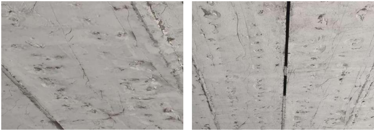
(a) 2-5#空心板板底，纵向裂缝 L=5.00m， W=0.15mm (b) 2-6#铰缝勾缝脱落 L=1.50m
