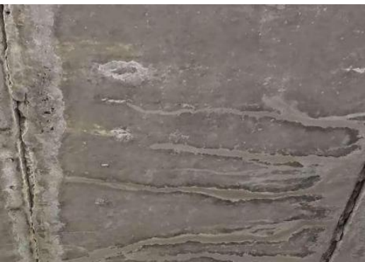
(b) 3-4#空心板板底，横向裂缝 N=3 条， L=2.00m ， W=0.10mm
