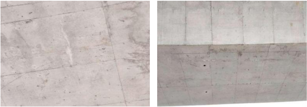
(a) 5-1#箱梁梁底，距 5#墩 5m 处，泛白吸附纵向裂缝 L=1.00m，W=0.10mm (b) 5-1#箱梁梁底，距 4#墩 3m 处，距右边缘 1m 处，纵向裂缝 L=5.00m，W=0.10mm
