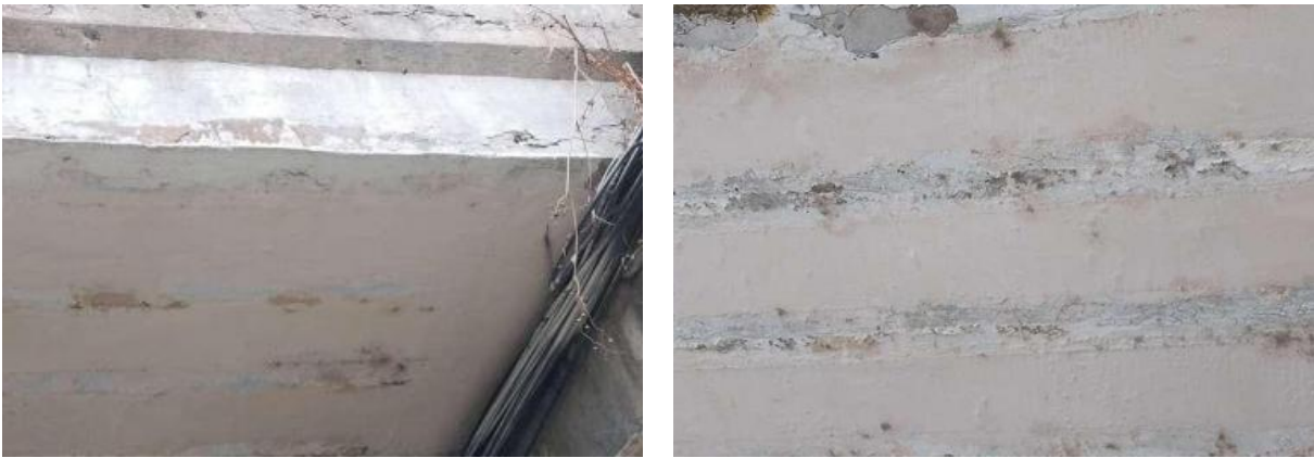
(a) 1-7#空心板破损 S=0.20m^2 ，且主筋外露 (b) 1-4#空心板板底，开裂，表面
