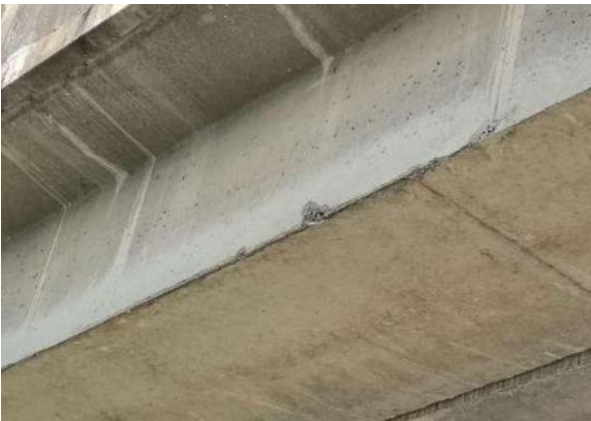
(a) 1-1#空心板右腹板，破损 N=3 处， S=0.03\text{m}^2
