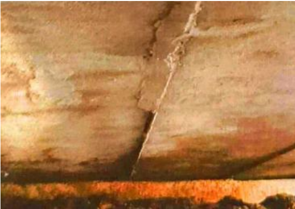
(a) 1-4#一般构件勾缝脱落 L=2.00m
