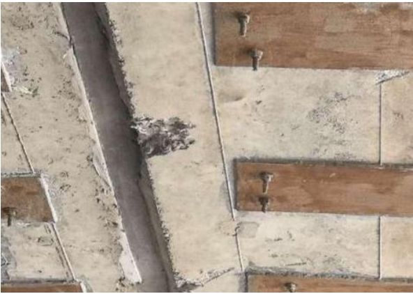
(b) 2-6#空心板板底，距 2#墩 9m 处，剥落 S=0.02m^2
