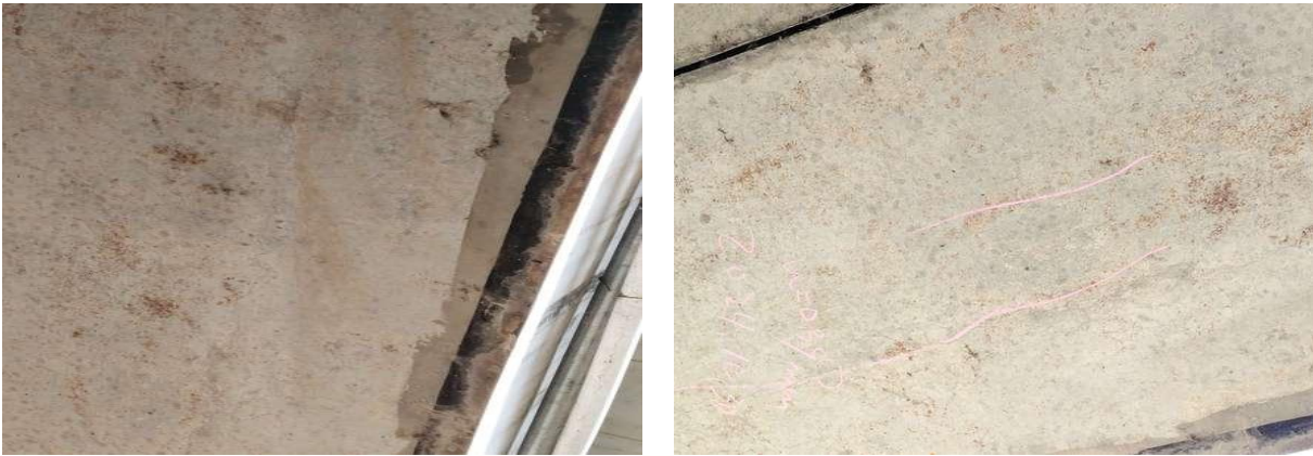
(a) 1-25#空心板板底，纵向裂缝 N=2 条， L=26.00m ， W=0.39mm (b) 1-25#空心板板底，纵向裂缝 N=2 条， L=26.00m ， W=0.39mm
