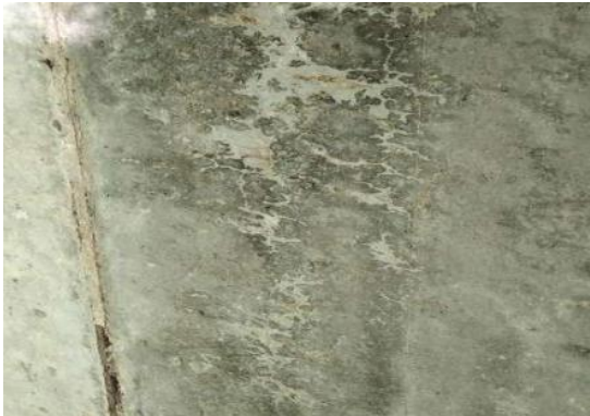
(a) 1-3#空心板板底，纵向裂缝 N=2 条， L=10.00m ， W=0.12mm
