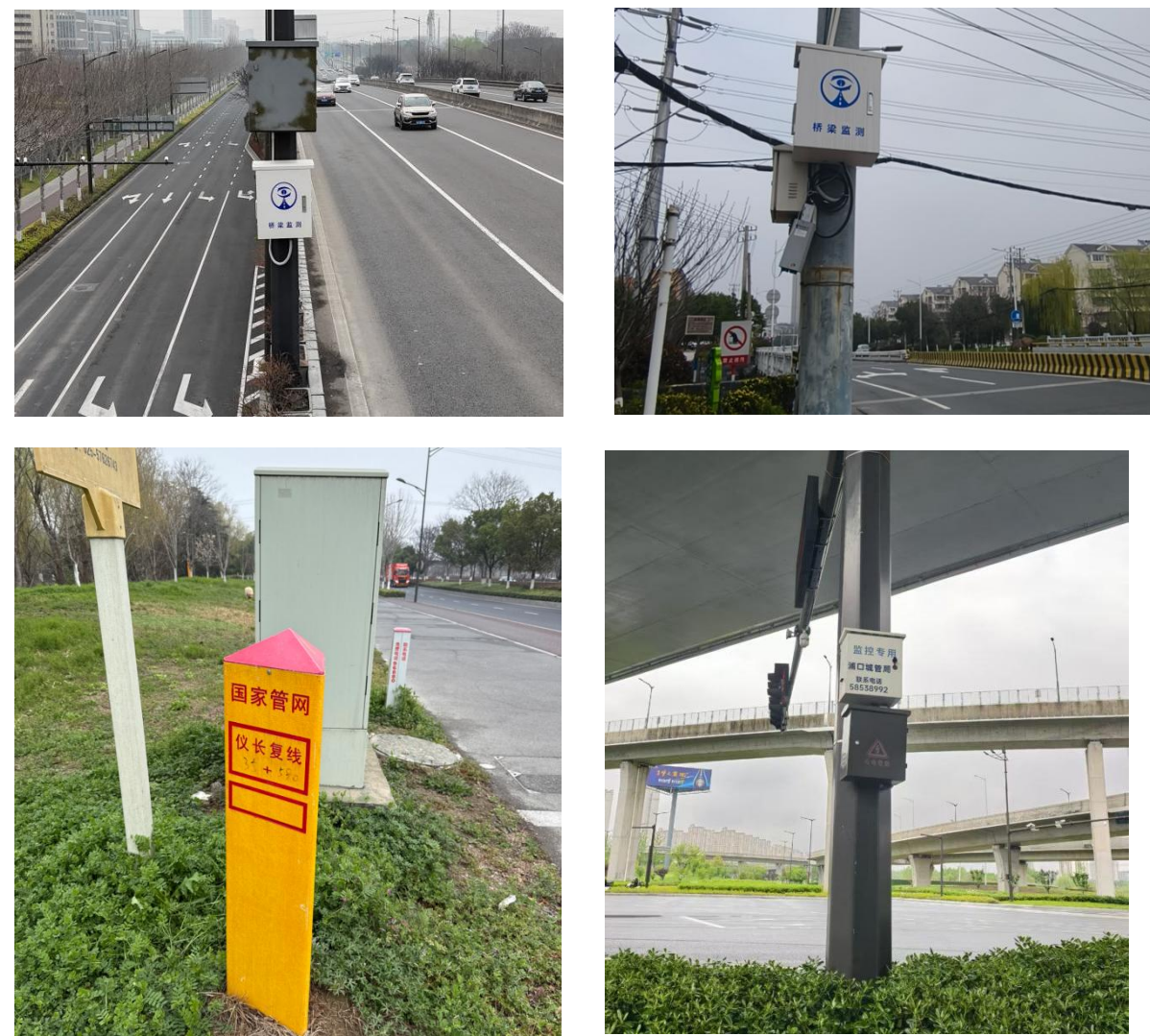
图 3.3-1 现场取电取网情况
