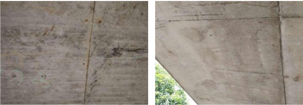
(a)16-1#箱梁梁底,距 16#台 4m 至 20m 范围内, (b) 14-1#箱梁右翼缘板,距 14#墩 2m 至 8m 范围内,纵向裂缝 L=16.00m, W=0.10mm 围内,横向裂缝 N=4 条, L=6.40m, W=0.10mm
