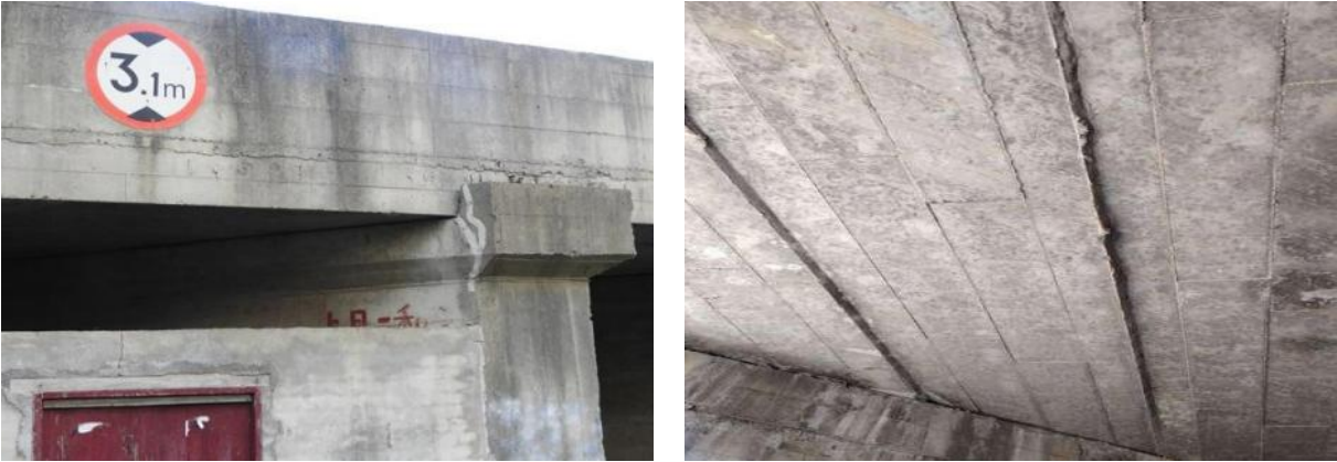
(a) 1-1#空心板右腹板，露筋 S=0.04\text{m}^2 ，多处
