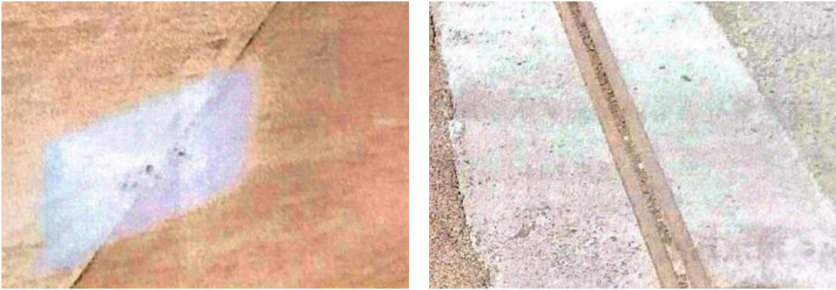
(a) 1-4#空心板板底，距 0#墩 5m 处，剥落
