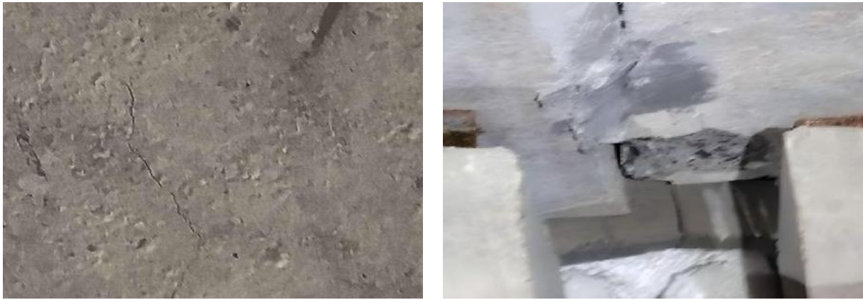
(a) 1-4#空心板板底，距 0#墩 2m 处，纵向裂缝 L=4.20\text{m} ， W=0.10\text{mm} (b) 1-8#空心板板底，距 1#墩 0m 处，剥落、掉角 S=0.01\text{m}^2
