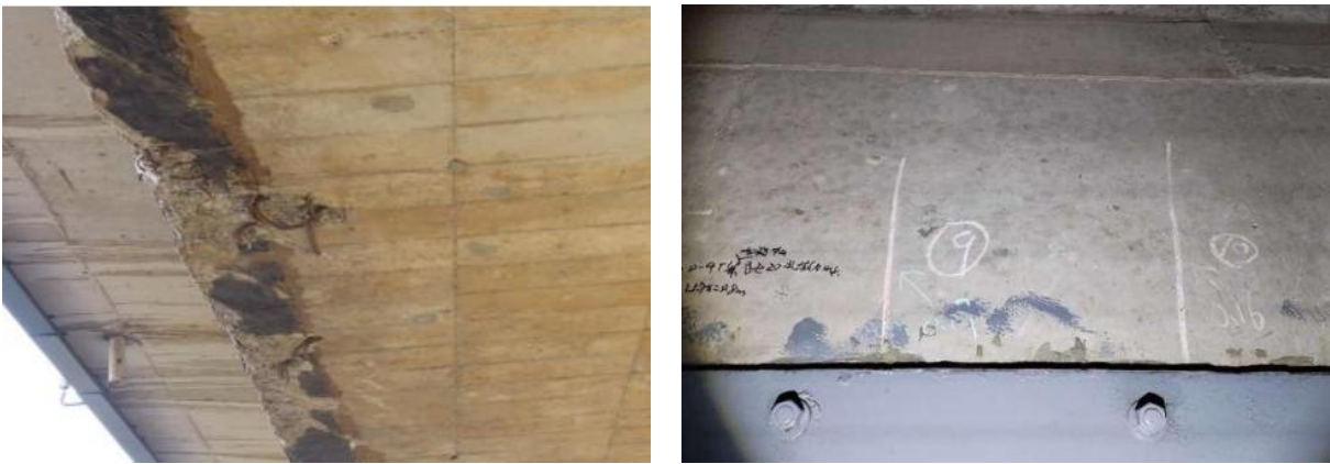
(a) 9#箱梁梁底，露筋 S=0.40\text{m}^2 ，车辆刮擦多处破损露筋 (b) 20-4#T 梁右腹板，距 20#墩 10m 处，竖向裂缝 N=2 条， W=0.12\text{mm}
