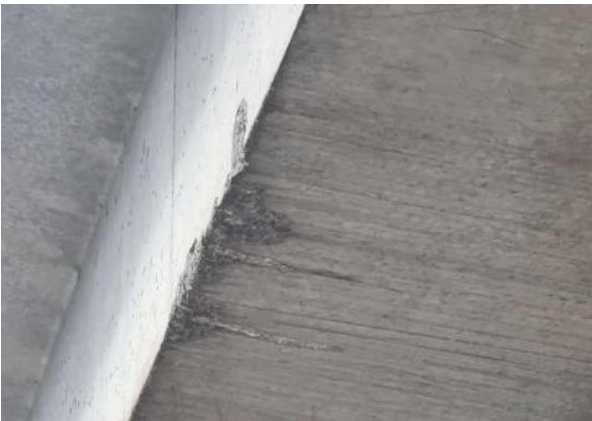
(b) 2-1#空心板板底，距 2#墩 10m 处，破损 N=3 处， S=0.03\text{m}^2 ，与腹板交界处刮擦
