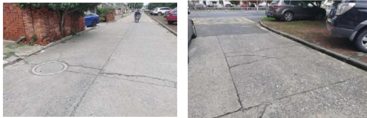
图 3-4 混凝土路面病害
