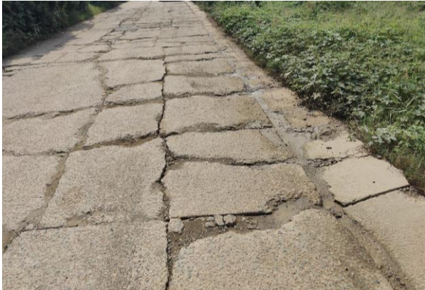
路面病害破碎板
