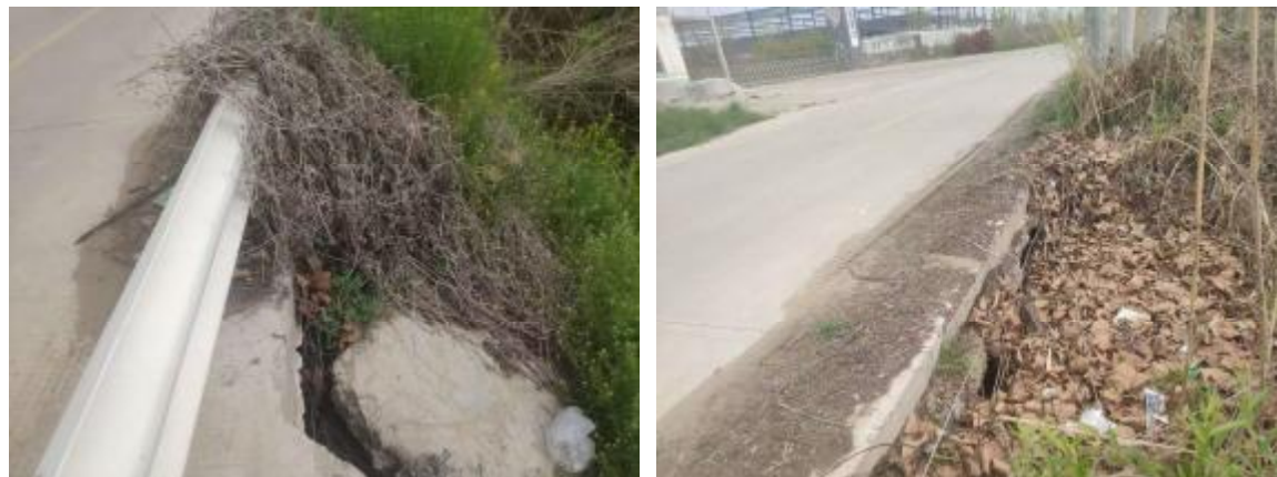
图 3-4 道路路基现状
