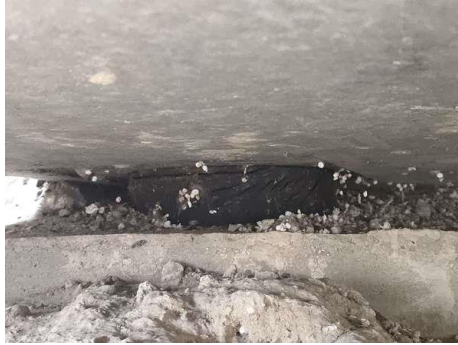
第3幅 1-0-1#支座开裂
