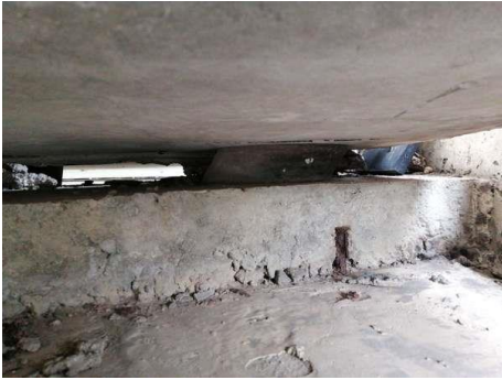
第2幅 5-5-1#支座剪切变形
