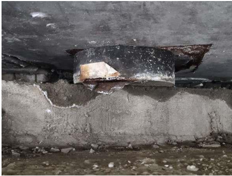
第4幅 1-0-7#支座移位
