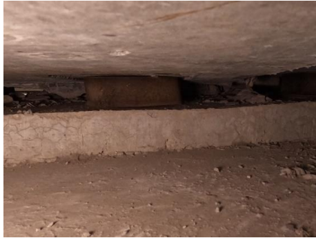
第2幅 2-1-10#支座开裂
