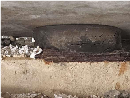
第4幅 1-0-2#支座开裂
