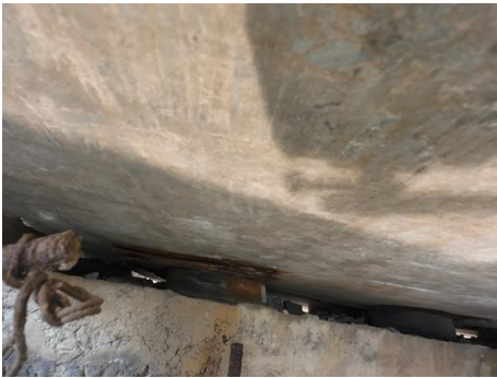
第1幅 4-3-1#支座剪切变形
