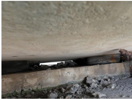
第1幅 3-3-1#支座剪切变形
