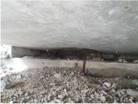
第3幅 4-4-24#支座剪切变形
