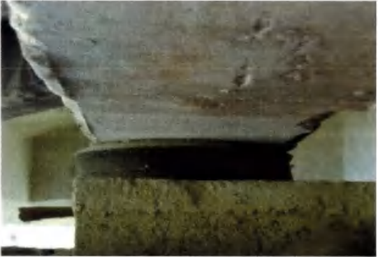
支座老化变质、开裂
