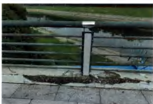
人行道侧护栏底座混凝土风化剥落
