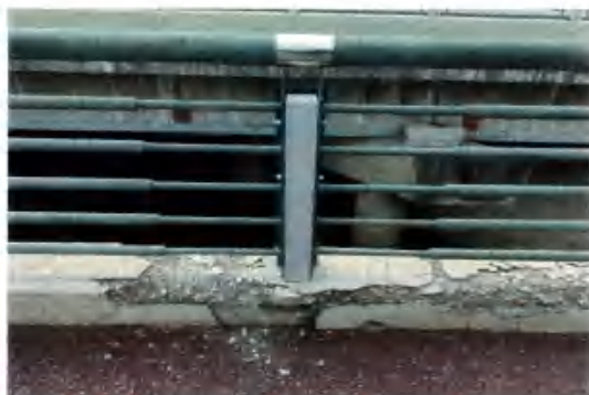
底座后加高混凝土风化松散
