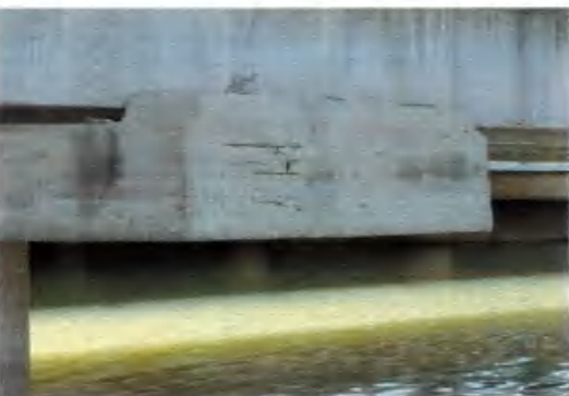
盖梁侧面，锈胀露筋
