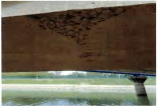
盖梁底面露骨
