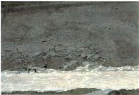
腹板混凝土剥落
