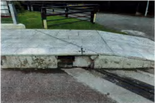
人行道伸缩缝变形空间不足
