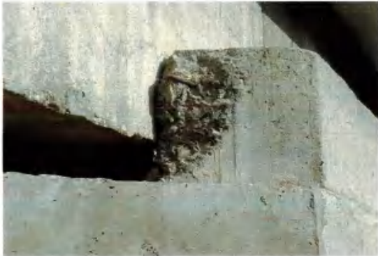
剥落锈胀露筋
