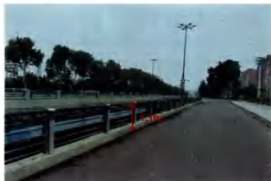
非机动车道栏杆高度不足
