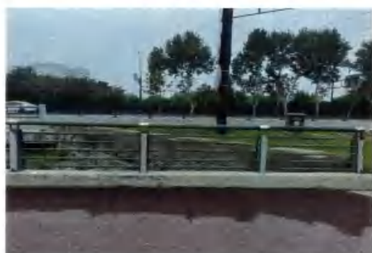
底座表面涂漆掉落
