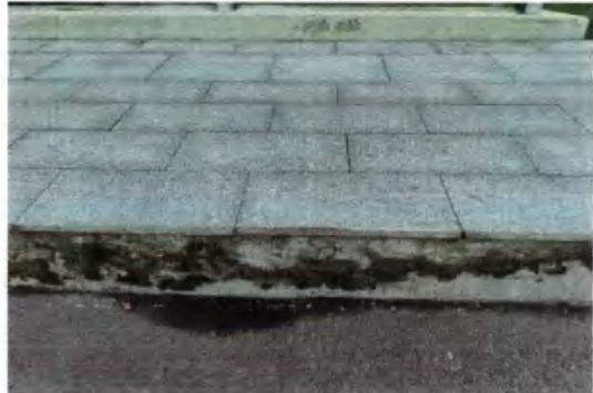
混凝土松散脱落
