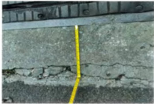
锚固区混凝土破碎
