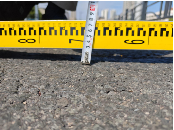
车辙 1（海棠路交叉口）
