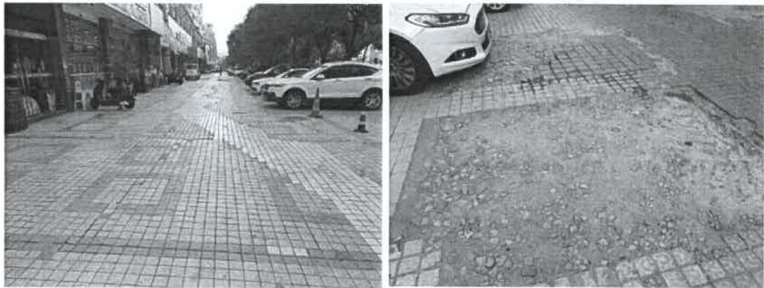
开挖恢复不到位，局部破损严重
