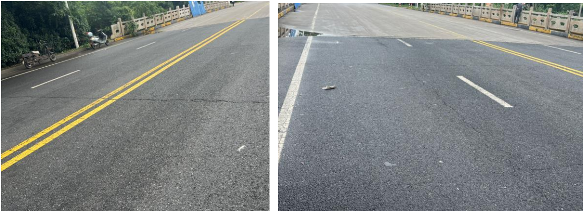
龙园桥以北反射裂缝
