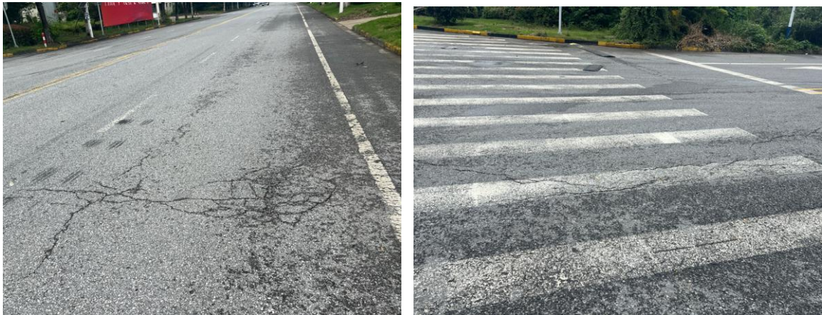
龙园桥以南龟裂、沉陷
