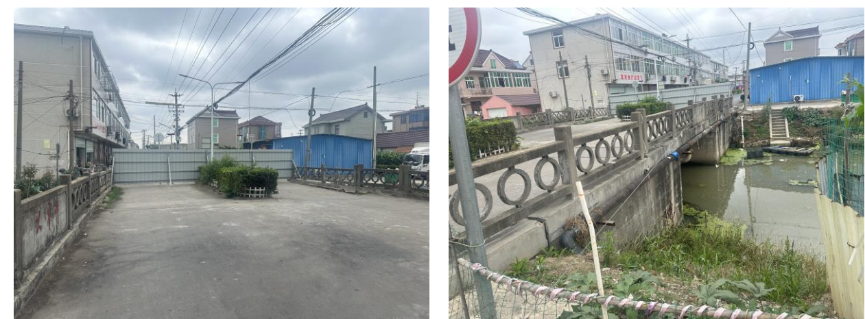
图 1-1 正余镇 大岸桥老桥现状
