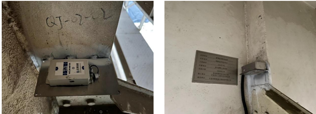
图 6.5-5 倾角仪现场照片
