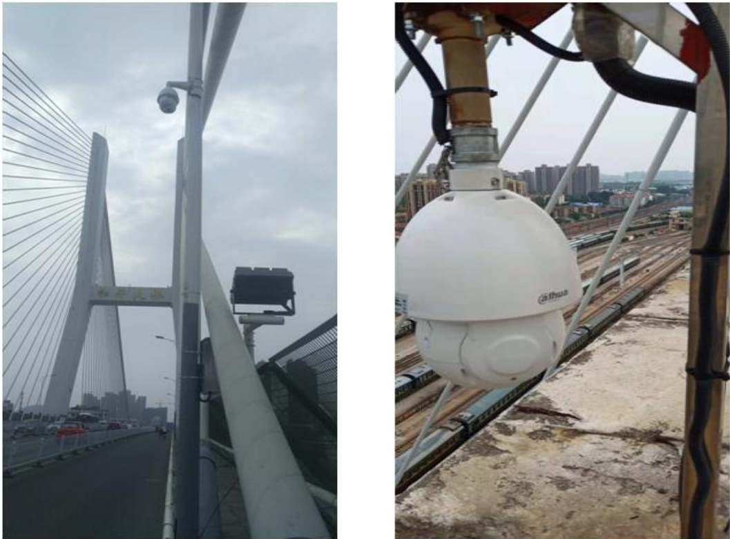
图 6.5-9 高清摄像头现场照片
