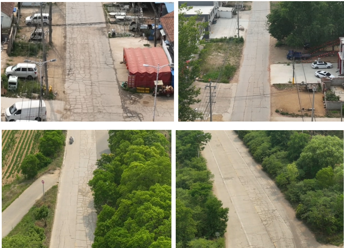
图 4-5 道路路面病害照片
