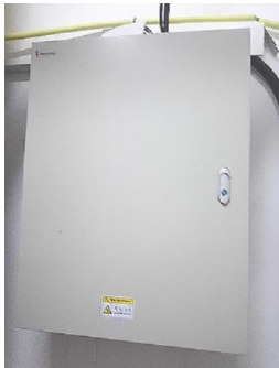
辅助配电箱面板照片
