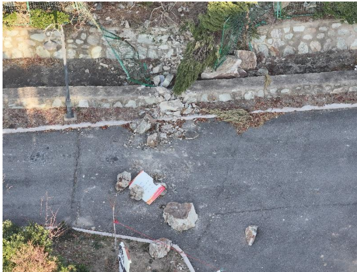
图 3-9. 崩塌体滚落至坡脚道路
