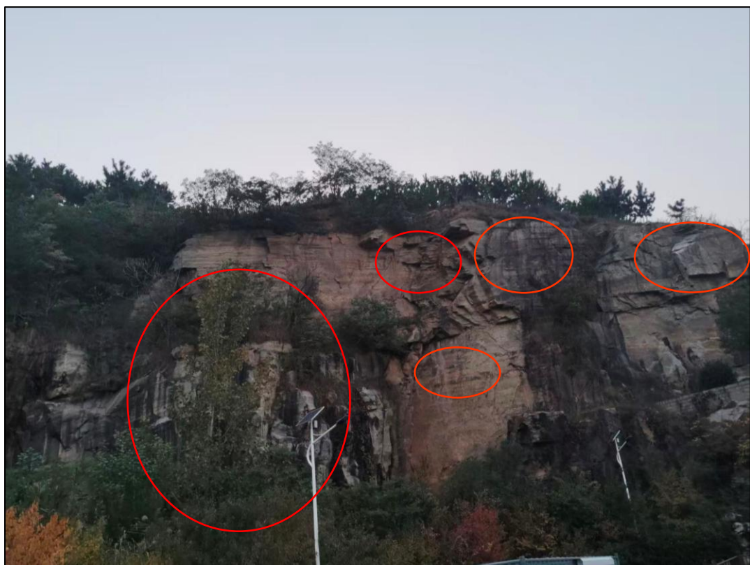
图 3-4 边坡坡面仍存在危岩体
