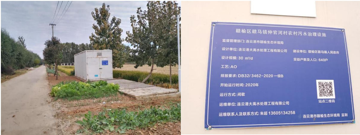
图 3-1 现状污水处理站
