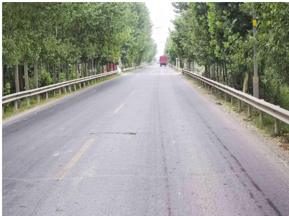
破损严重路段终点
