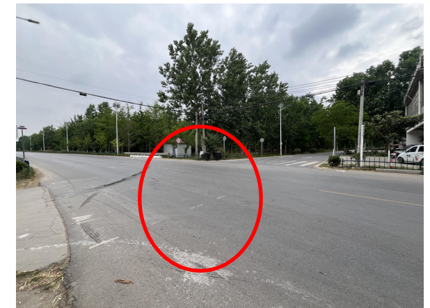
交叉口标线磨损严重
