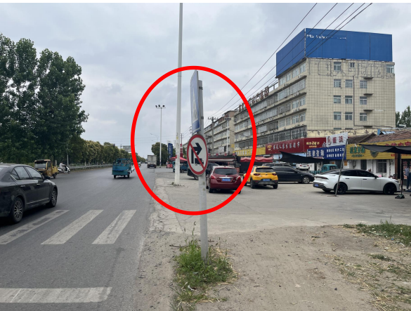
标牌立柱高度不够且版面方向不对
