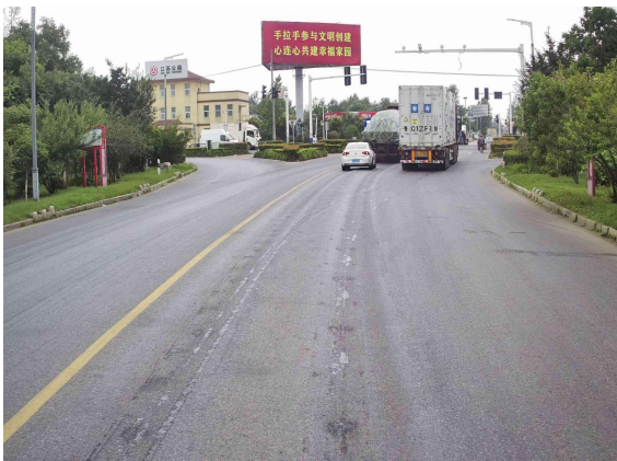
车辙严重路段起点
