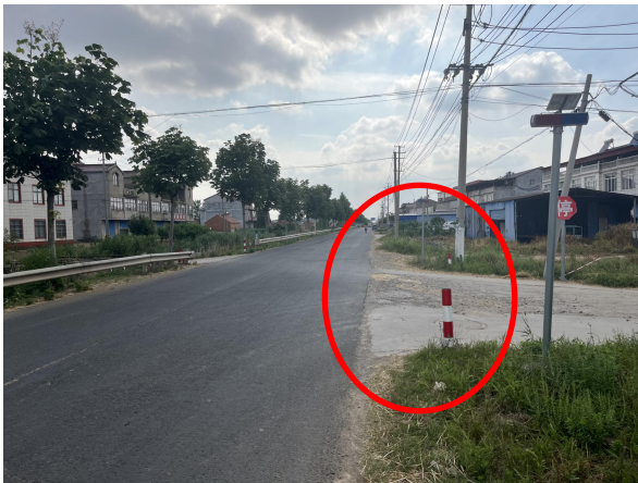
道口标柱缺少、损坏
