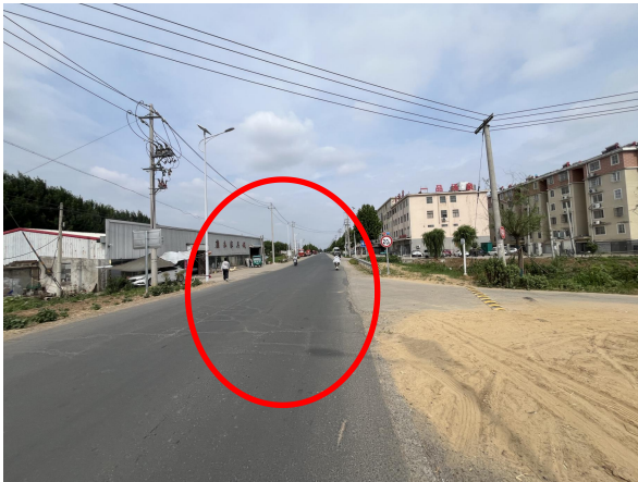
交叉口标线缺失、磨损严重
