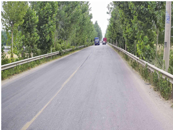
破损严重路段起点
