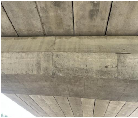
1#墩盖梁中部钢筋锈
