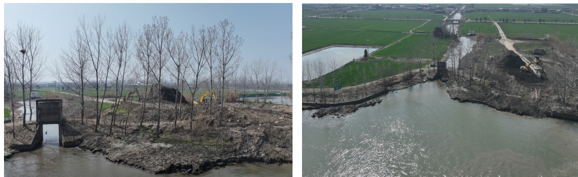
图 3-1 航道边坡坍塌严重段及堆土段
