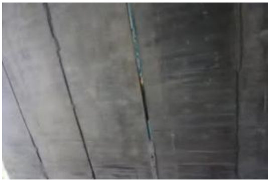
第 1 孔 3#铰缝勾缝脱落
