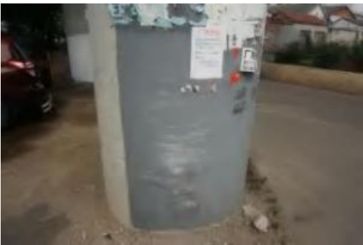
第 9 孔 9#墩 2#立柱车辆刮擦
