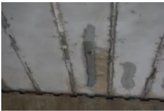
第 1 孔 8#底板渗水
