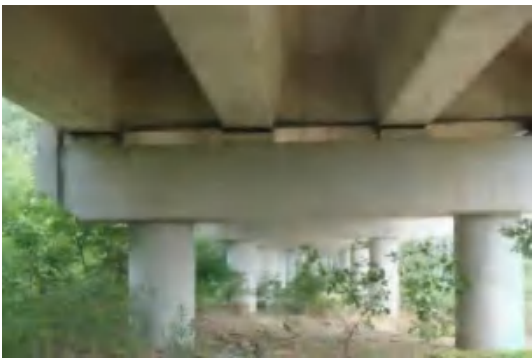
第 5 孔 5#墩 1#盖梁水渍侵蚀
