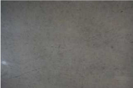
第 1 孔 1#底板斜向裂缝
