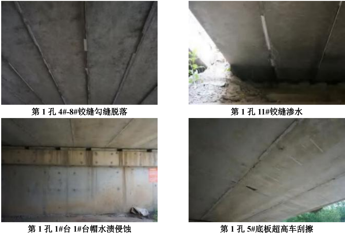
图 3.1-14 八府通道病害照片
