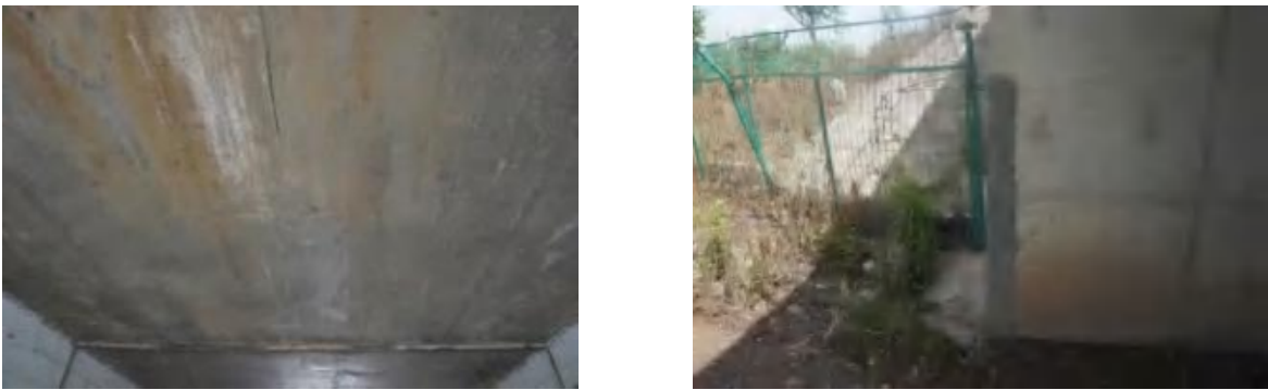
第 1 孔 1#底板超高车刮擦 第 1 孔 0#台 1#台身剥落
