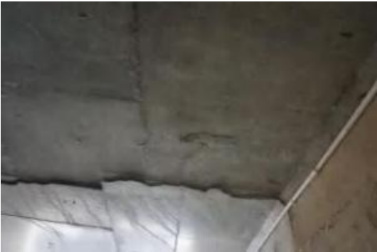
第 1 孔 1#底板钢筋锈胀
