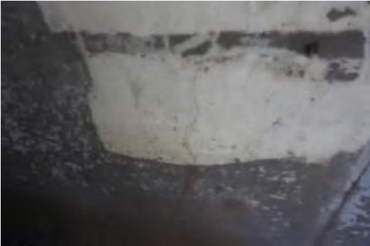
第 1 孔 1#台身竖向裂缝
