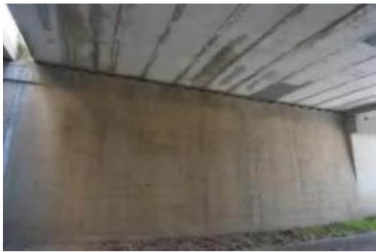
第 1 孔 0#台 1#台身水渍侵蚀
