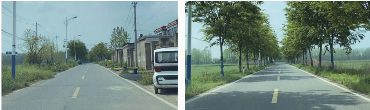
叉小线裂缝、麻面
