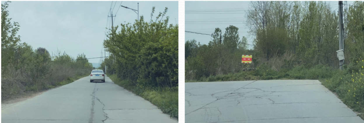
花园路板块破碎、裂缝、错台
