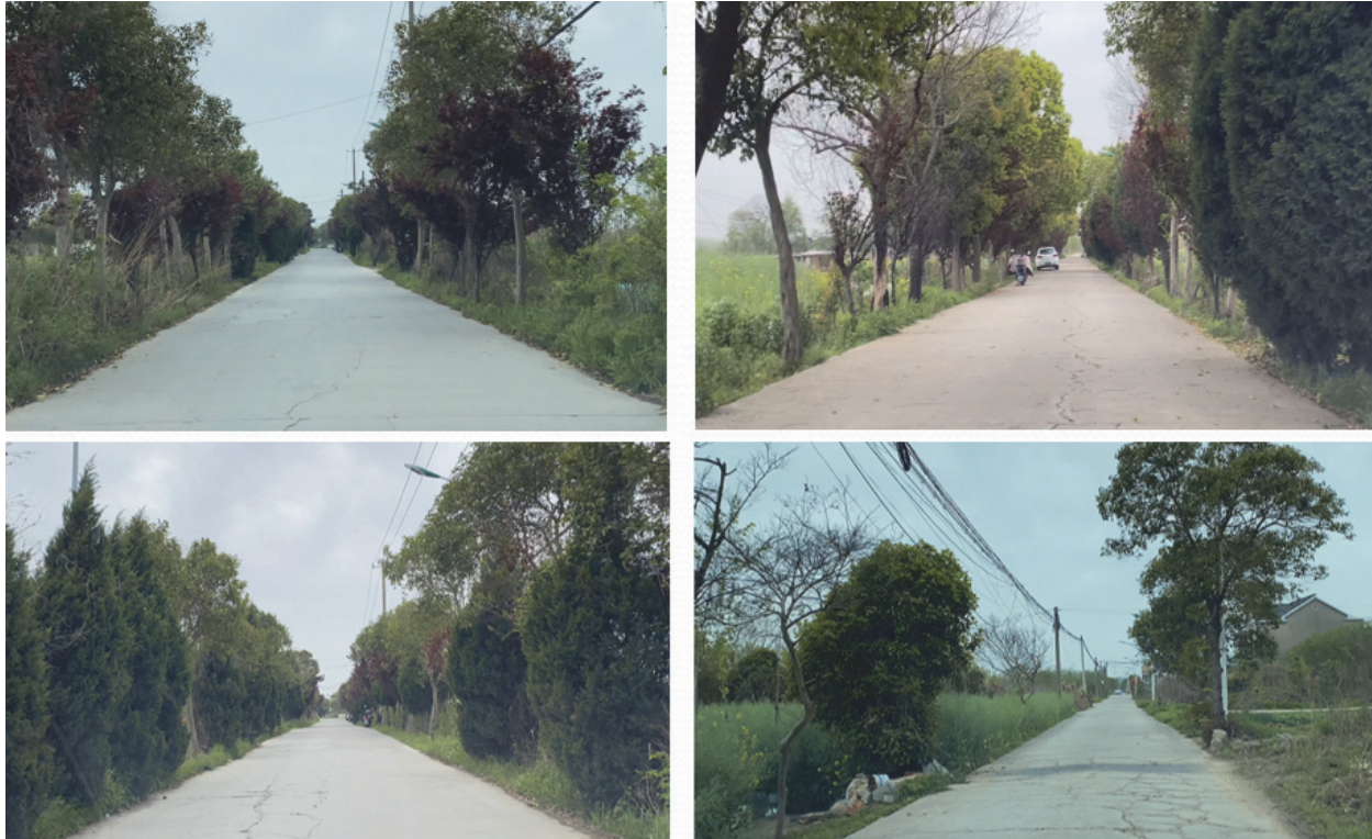
四柳路板块破碎、裂缝、错台
