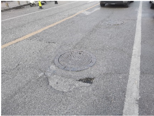
井周路面破损
