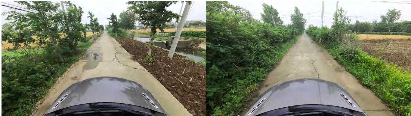
纵向、横向裂缝、破碎板
