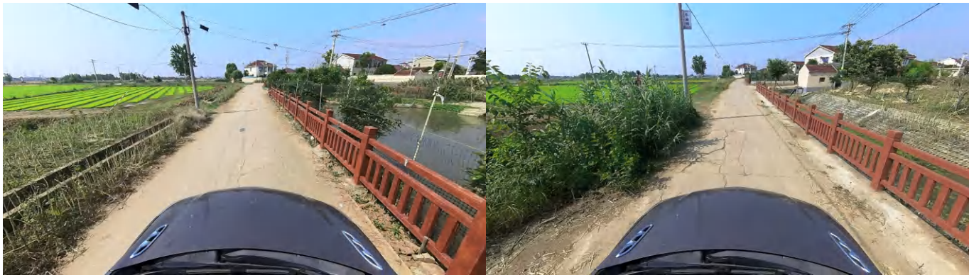
横向裂缝、纵向裂缝、破碎板
