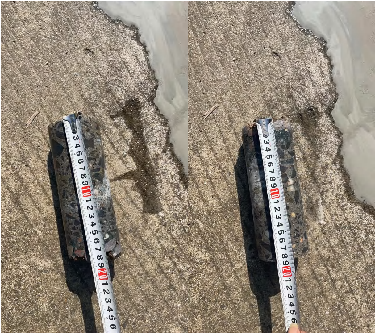
傅黄线（取芯完整，混凝土厚度约 18cm）
