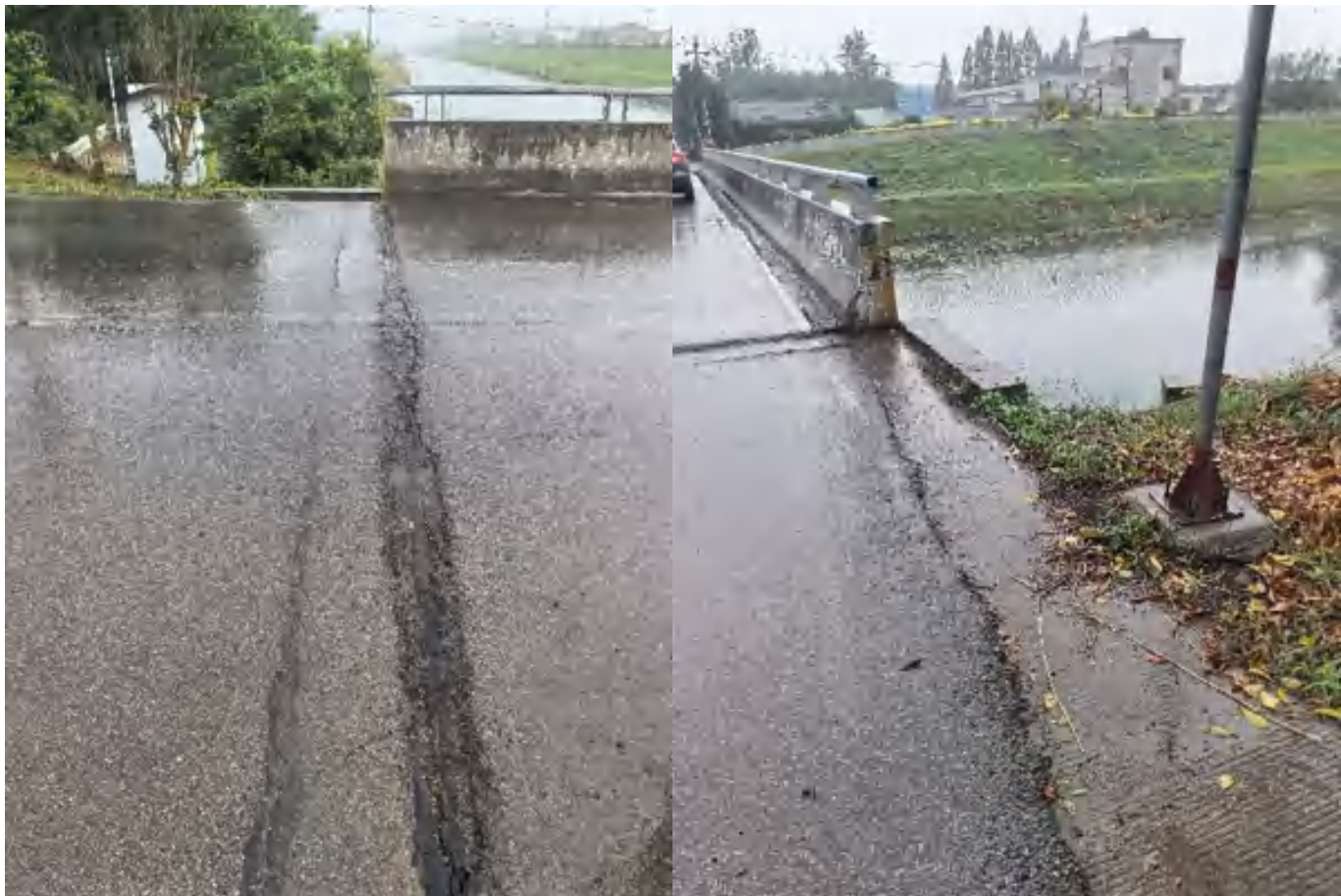
横向裂缝、纵向裂缝、桥梁现状铺装、桥头伸缩缝破损、护栏长度不足
