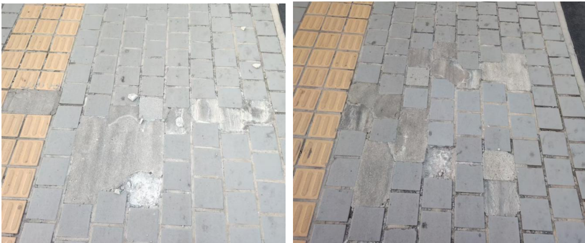
图 2.3-1 人行道铺装损坏
