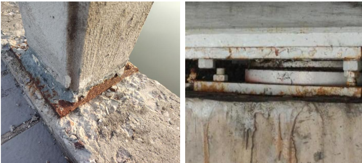
图 5.2-13 栏杆基座钢板和支座钢盆锈蚀
