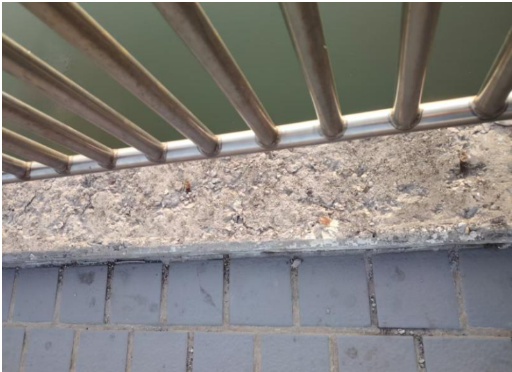
图 5.2-14 栏杆基座混凝土破损
