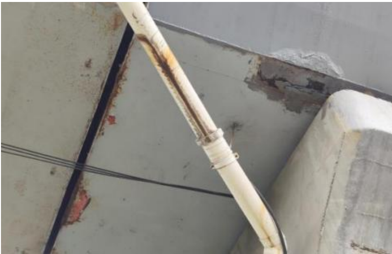
图 2.2-4 现状泄水管破损
