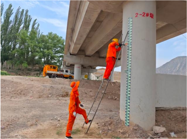
图 5.2-16 增设汛期水位尺
