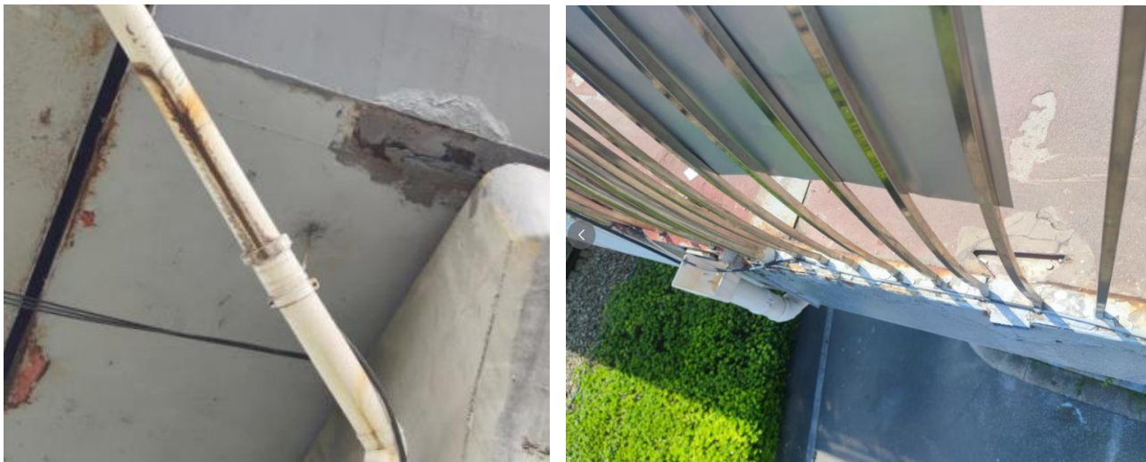
图 5.2-10 现状泄水管破损及缺失
