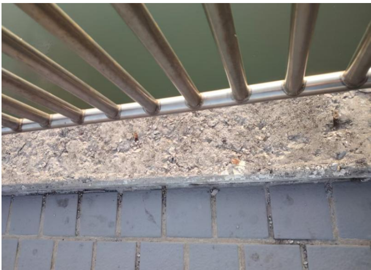
图 2.3-4 栏杆基座混凝土破损
