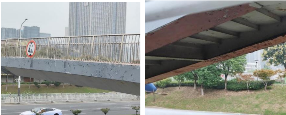
图 2.2-2 钢箱梁涂装脱落及锈蚀
