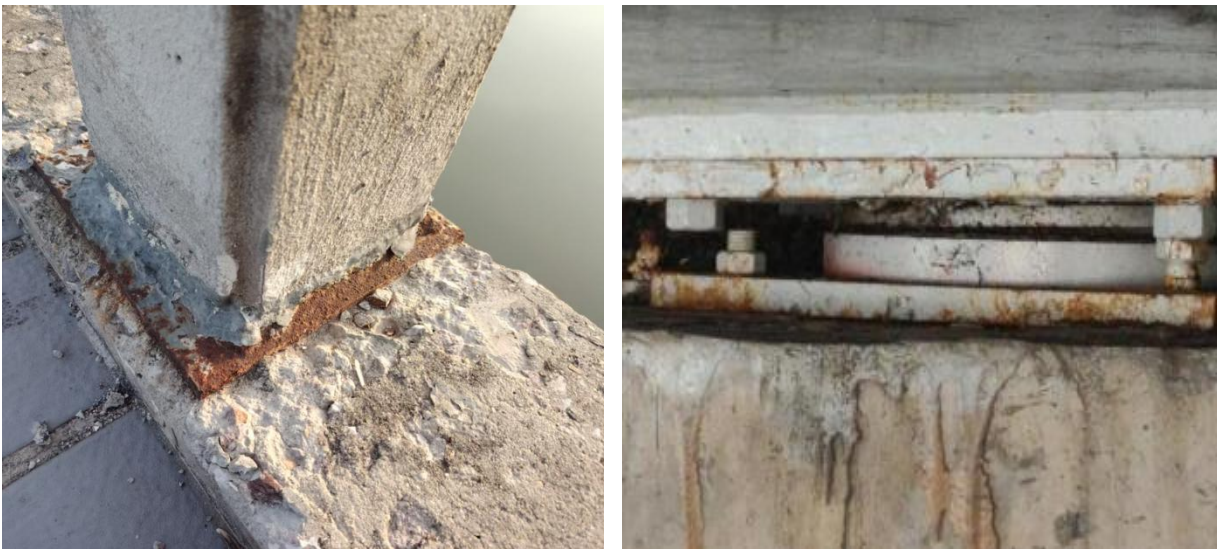
图 2.3-3 栏杆基座钢板和支座钢盆锈蚀
