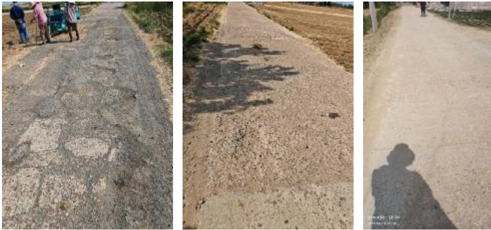
水泥混凝土典型病害
