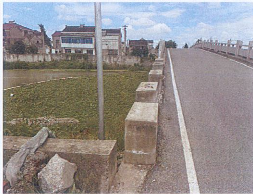
桥头纵坡大、示警墩缺少警示
