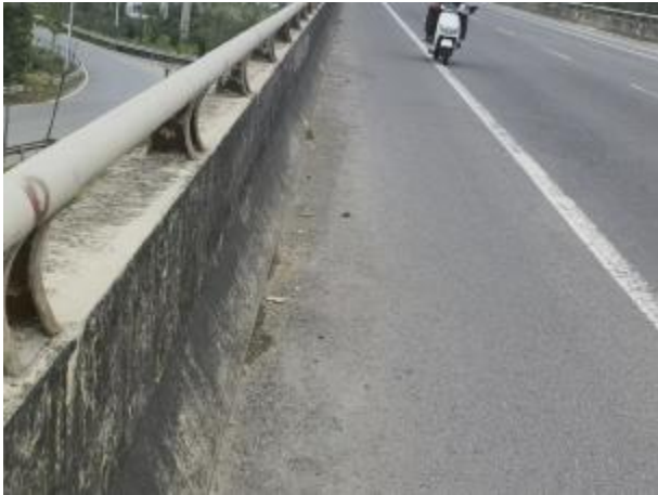
东侧部分泄水管堵塞
