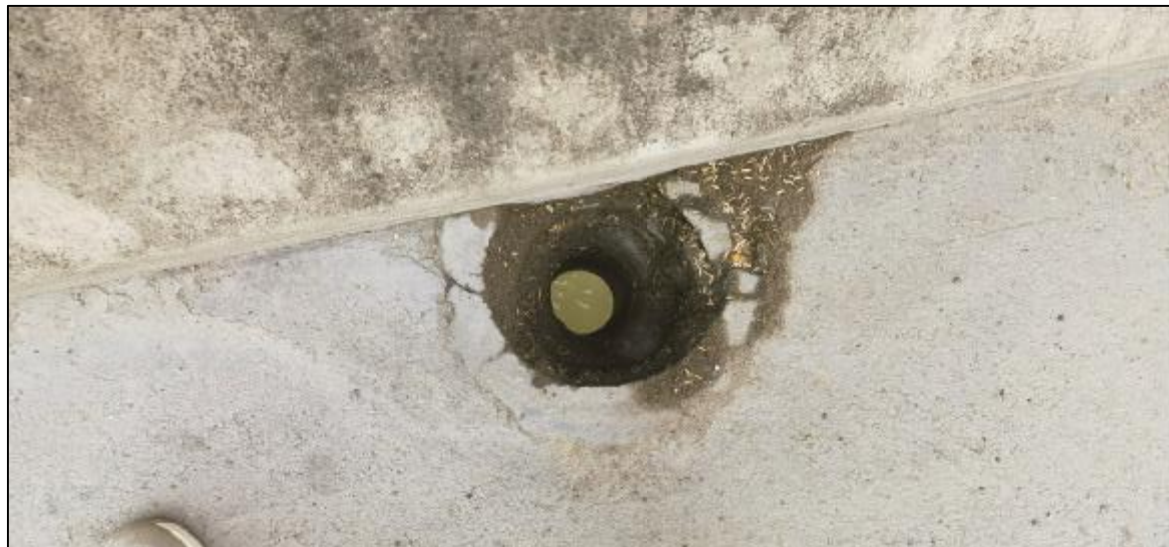
主桥东侧现状泄水孔
