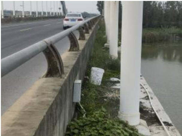
系梁顶面吊杆处长满杂草
