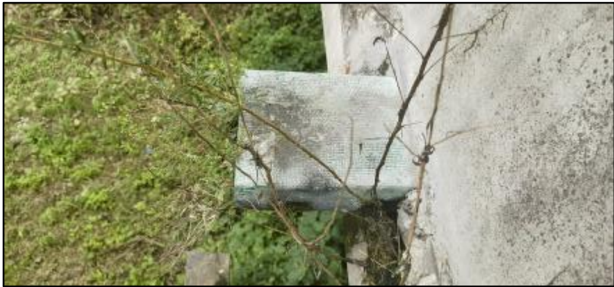
老桥现状单个玻璃钢泄水管（出水口老化，堵塞）
