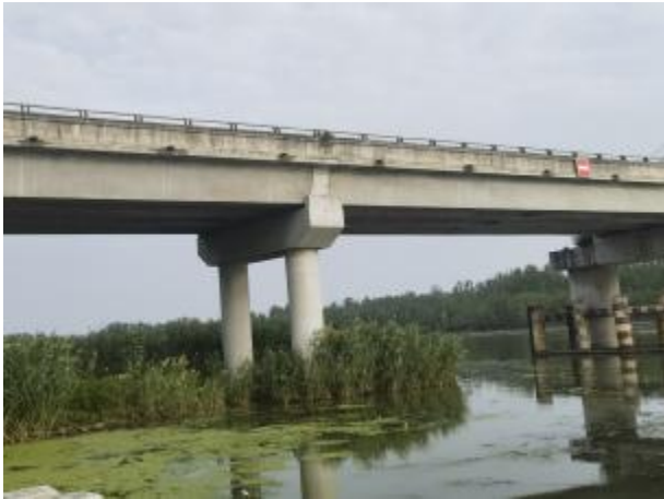
东侧部分泄水管横向排水未收集
