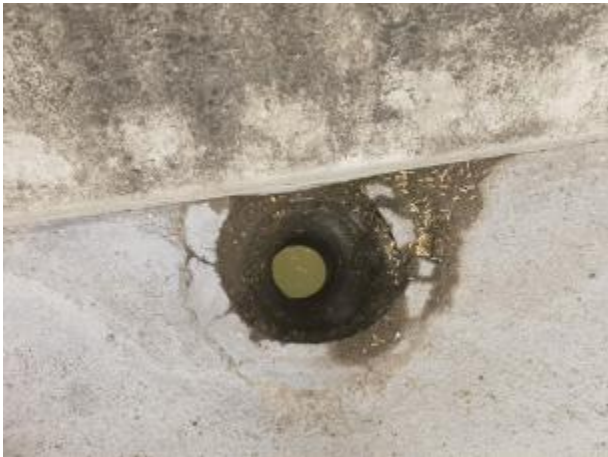
主桥部分泄水管盖缺失
