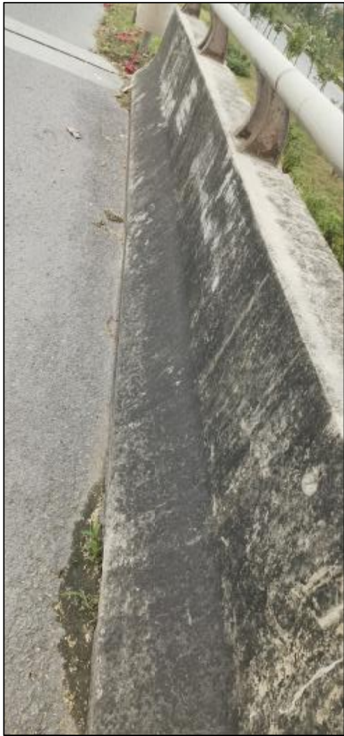
老桥现状单个玻璃钢泄水管（泄水管盖堵塞）
