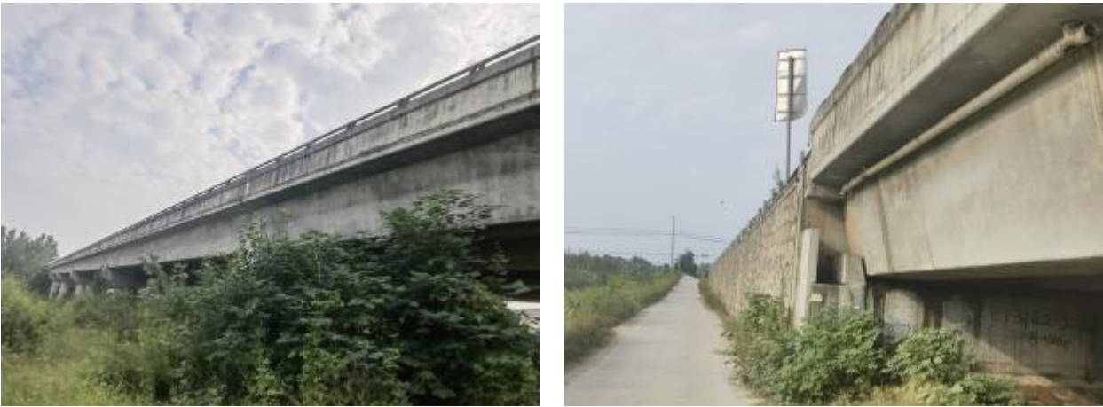
西侧未设置泄水管
