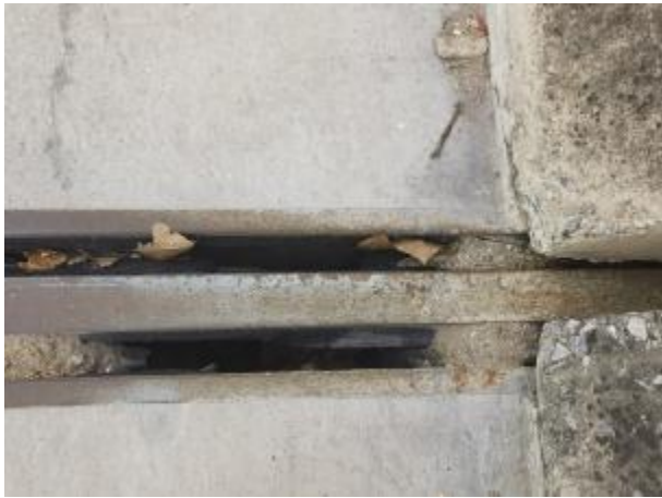
伸缩缝橡胶条缺失、损坏
