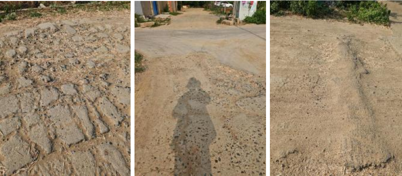
水泥混凝土典型病害
