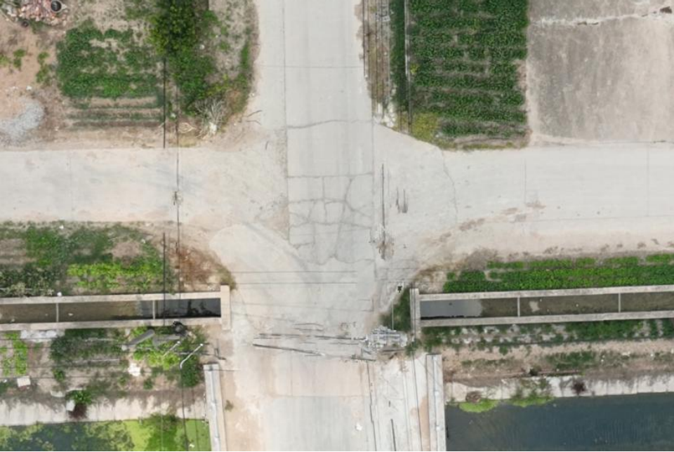
图 4-5-1 现状路面平整度调查图
