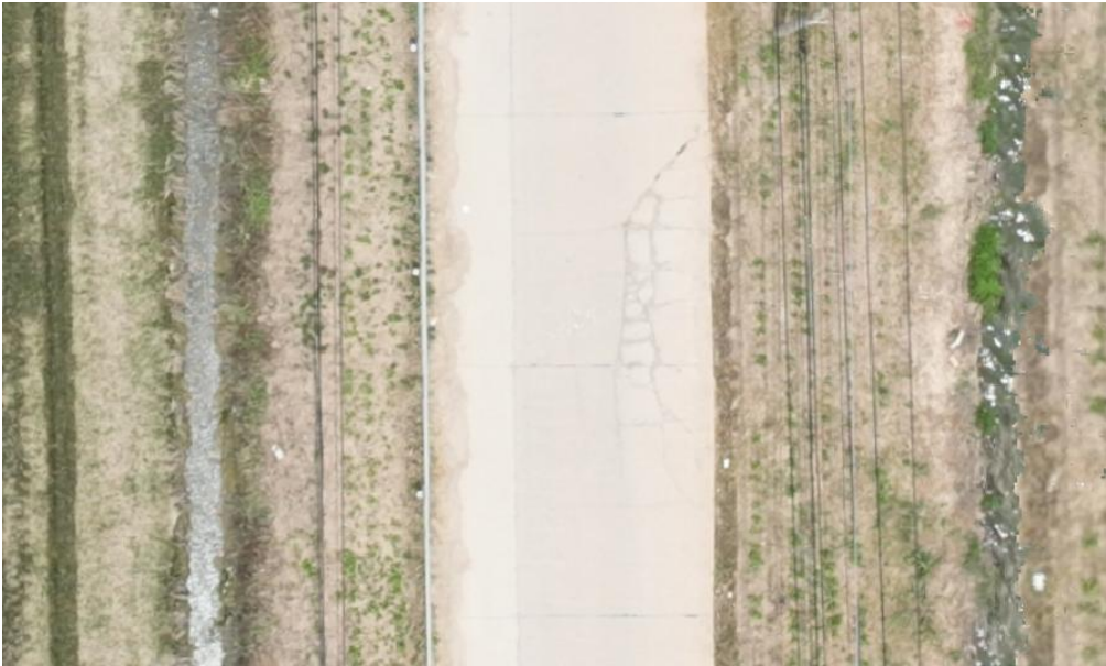
图 4-5-2 现状路面平整度调查图
