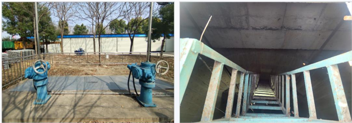
图 2.12 玉兰路泵站沉淀池实景
