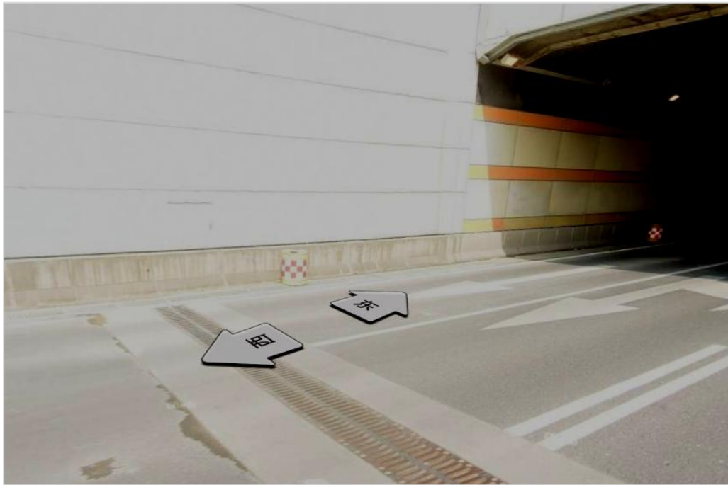
图 2.8 玉兰路隧道横向排水边沟实景 4（西侧洞口）
