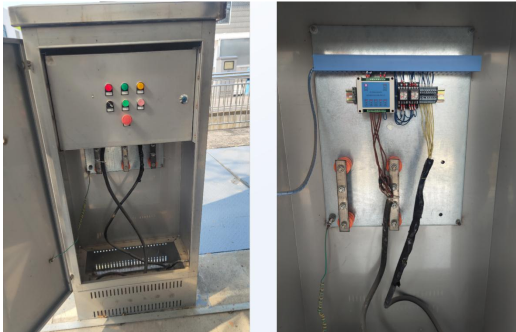
图 2.14 玉兰路泵站水泵控制柜现状
